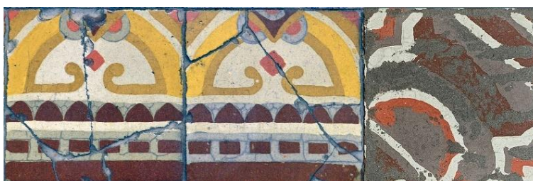
Figura 15 - Estado atual de conservação dos ladrilhos do Paço
