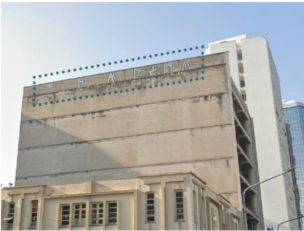
Figura 88 - Vista do Edifício Garagem Parobé em março de 2019. Fonte: Pesquisador, adaptado de Google, 2024.
