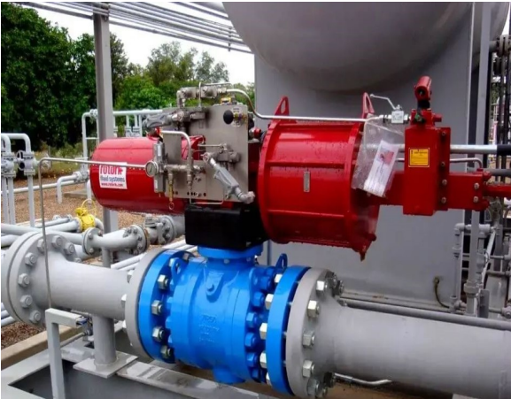
(a) Válvula instalada em uma tubulação.
