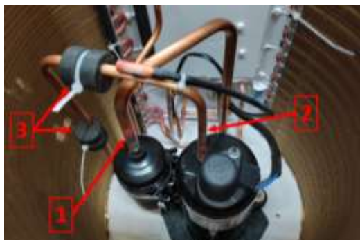
Figura 8: Conjunto de compressor e tubulações de sucção (1) e descarga (2) juntamente com atenuadores de vibração (3).
