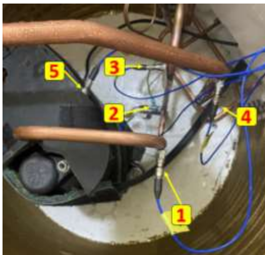
Figura 17: Posicionamento dos acelerômetros durante medições de FRF da segunda amostra de tubulação.
