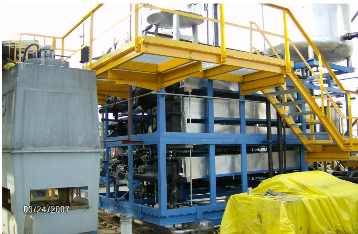
Figura 5.3 – Skid de condensação de vapores de hidrocarbonetos
