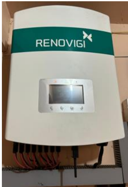
Figura 15 – Inversor fotovoltaico instalado no mercado Super Gringa.
