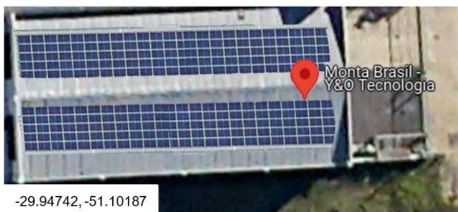
Figura 18 – Vista aérea dos painéis fotovoltaicos instalados na empresa Monta Brasil.
