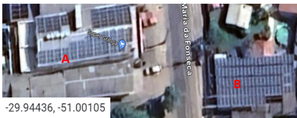
Figura 14 – Vista aérea dos painéis fotovoltaicos instalados no mercado Super Gringa.
