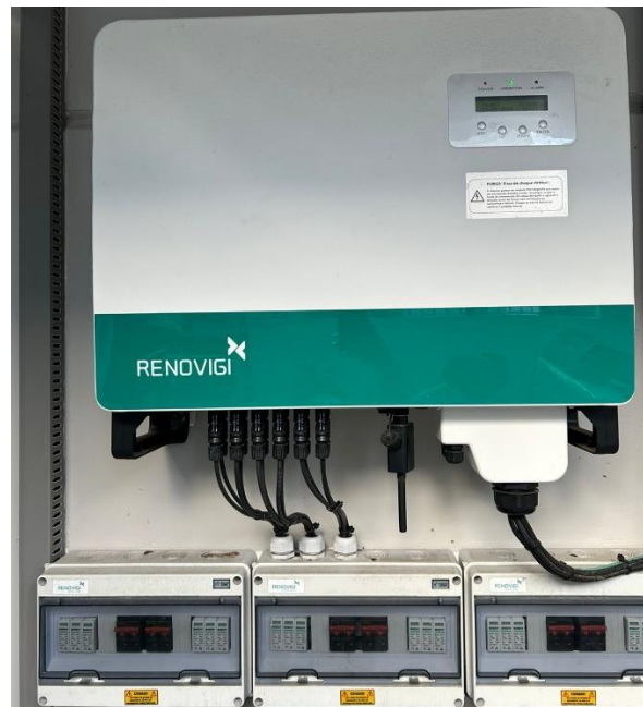
Figura 19 – Inversor fotovoltaico instalado na empresa Monta Brasil.
