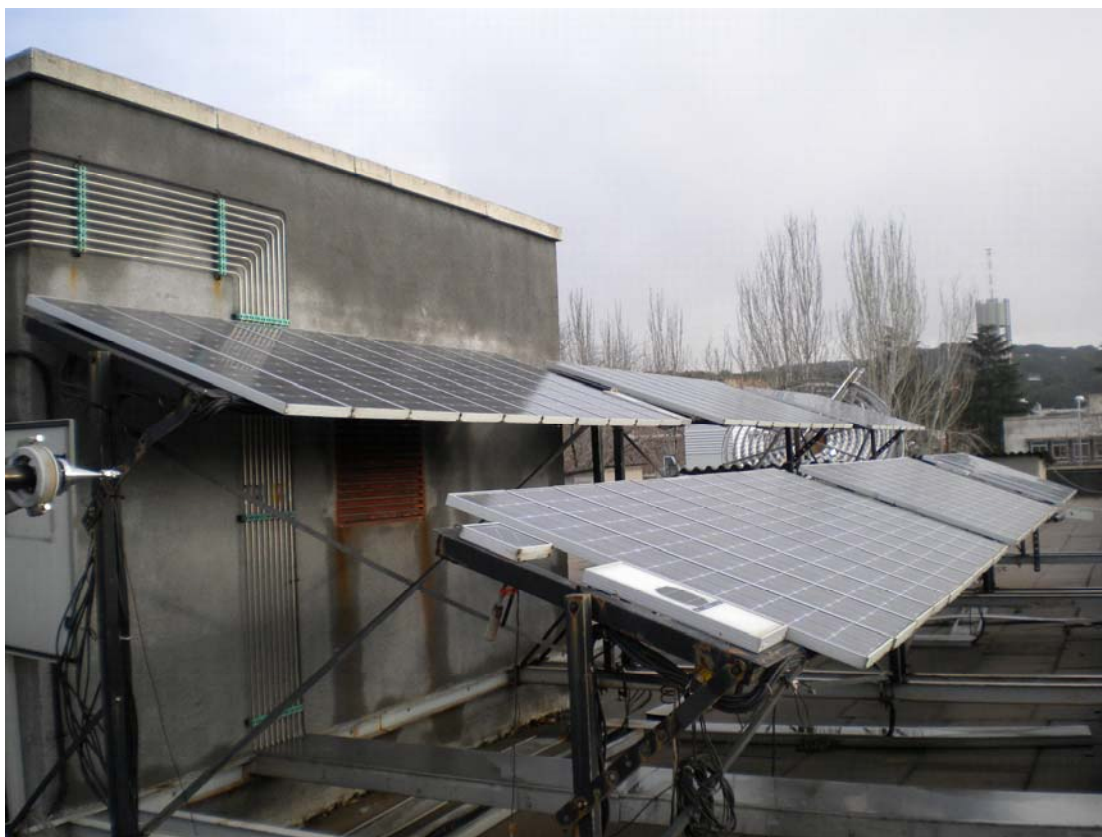
Figura 4.9 – Sistema fotovoltaico conectado à rede do Laboratório de Energia Solar Fotovoltaica do CIEMAT.
