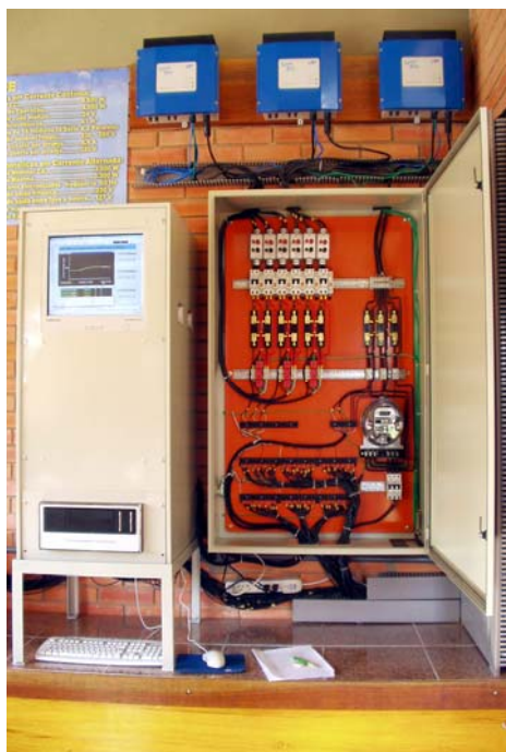
Figura 4.2 – Sistema de aquisição de dados, quadro elétrico e inversores CC/CA.
