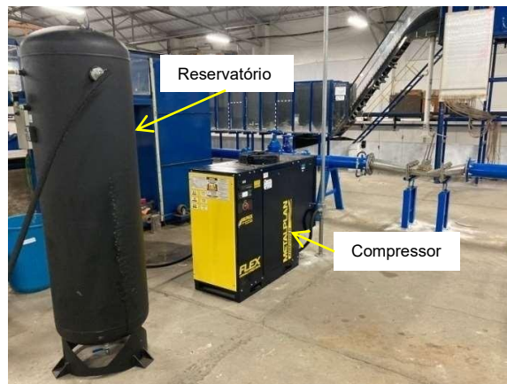
Figura 4-23: Sistema de geração e armazenamento de ar comprimido, reservatório e compressor de ar.
