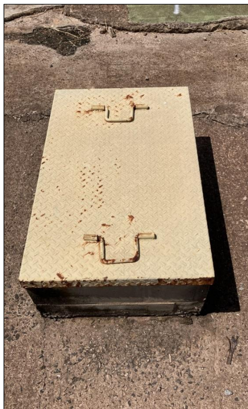
Figura 26: Caixa de inspeção do dreno passivo.
