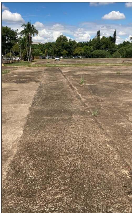
Figura 25: Linha onde se encontra o dreno passivo.
