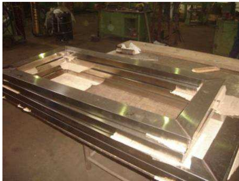
Suportes metálicos correspondentes aos módulos onde os equipamentos serão soldados para montagem da planta.
