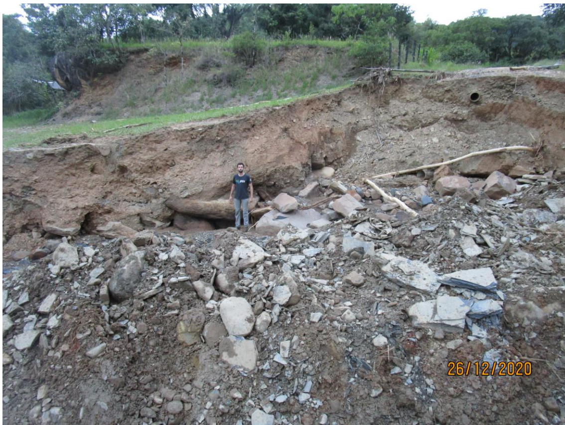
Figura 24: Foto no local em que o evento 1 destruiu a estrada Doutor Getúlio Vargas que ligava a localidade ao centro urbano de Presidente Getúlio.
