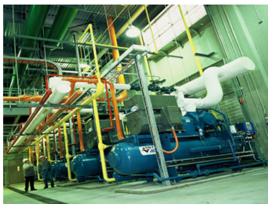
Figura 1.1 - Compressores em paralelo – Fonte Electromotion Refrigeration
