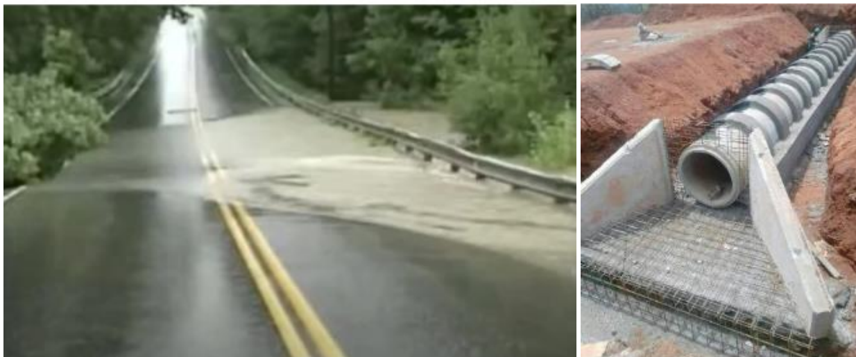
Figura 95 e 96 – Inundação de bueiro (esquerda) e bueiro em construção (direita)
