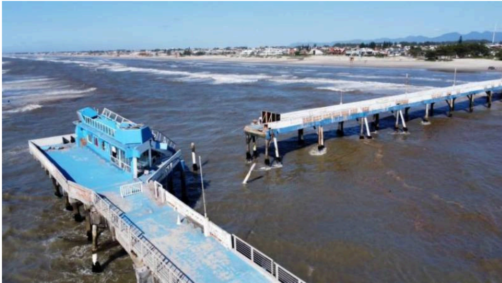
Figura 5: Colapso de parte da estrutura da Plataforma, ocorrido em outubro de 2023.
