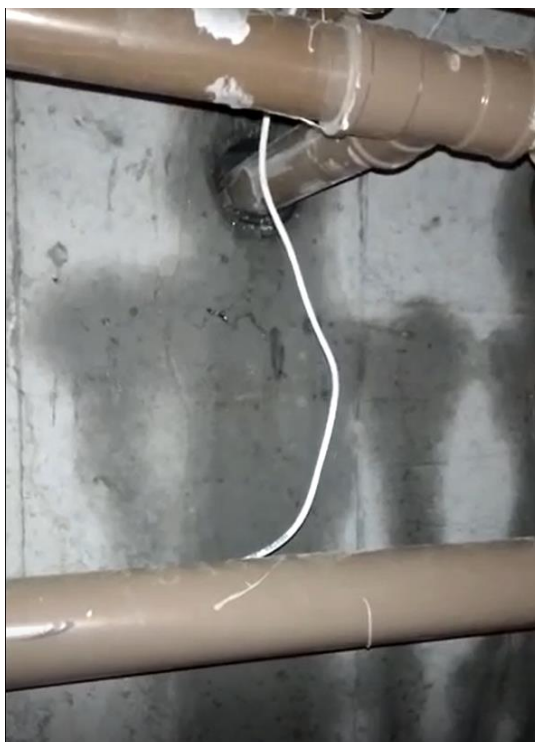
Figura 21- Ponto de vazamento junto à tubulação emergente
