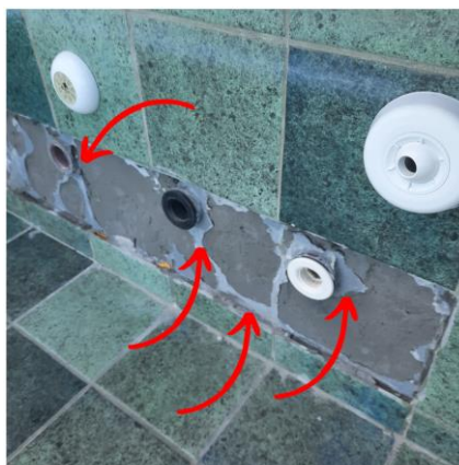
Figura 49 - Resquícios do sistema de impermeabilização executado inicialmente
