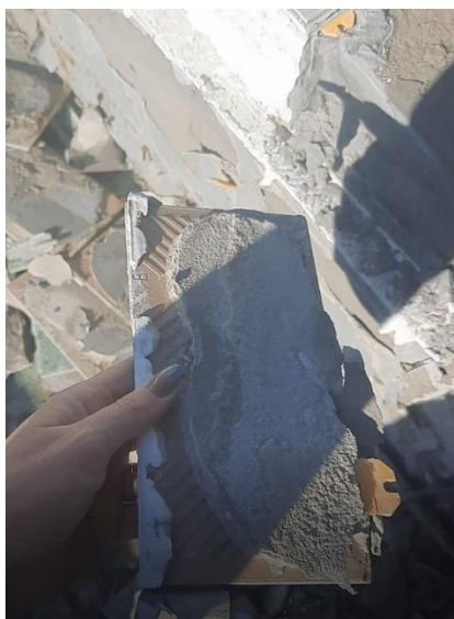
Figura 27 - Peças cerâmicas sem preenchimento de argamassa colante adequado
