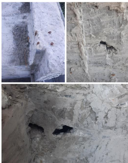
Figura 55 - Falhas na execução da concretagem
