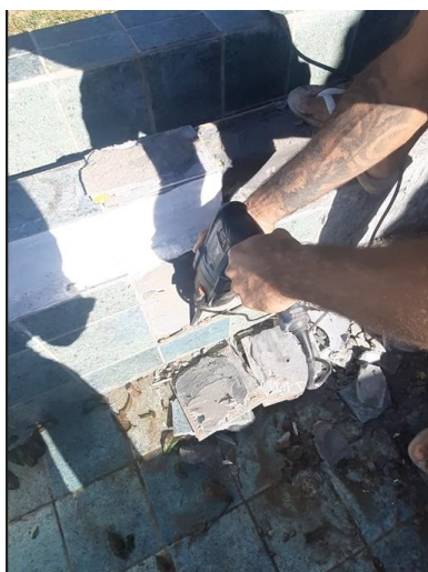
Figura 26 - Peças cerâmicas sem preenchimento de argamassa colante adequado
