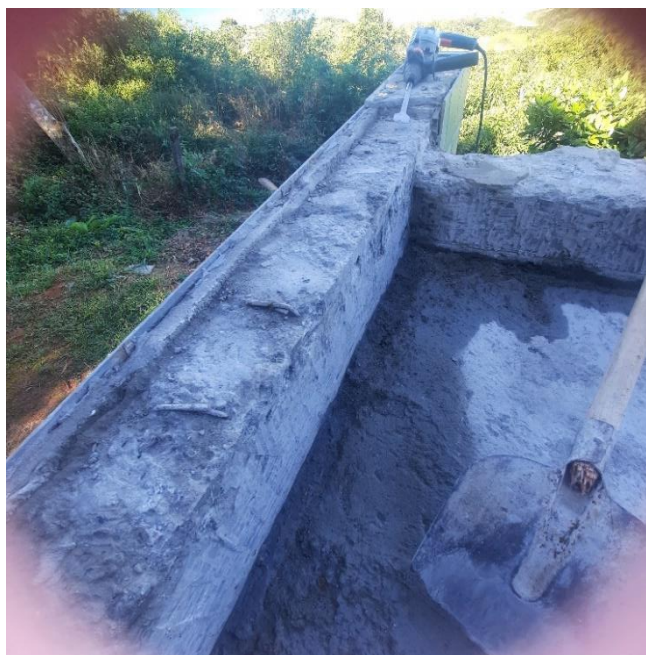
Figura 50 - Estribos a mostra após a retirada do revestimento inicial da estrutura
