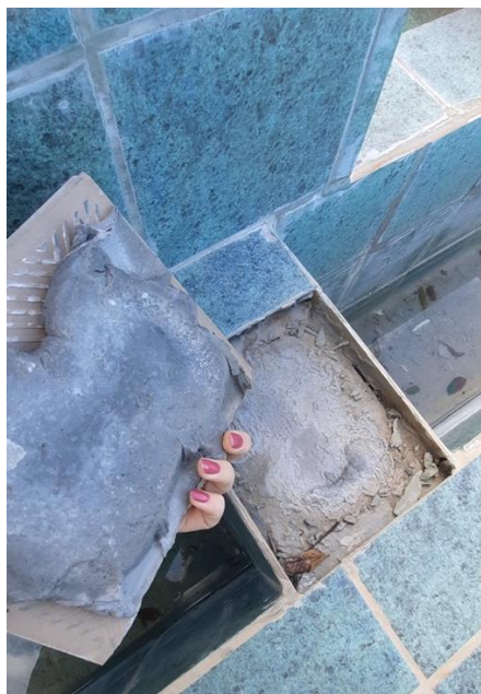
Figura 23 - Peça cerâmica deslocada
