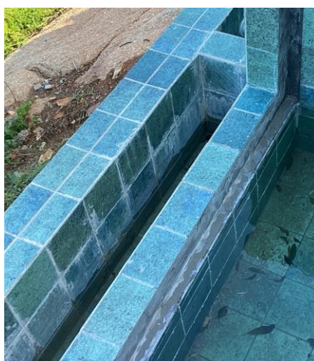
Figura 29 - Presença de eflorescências nas paredes externas
