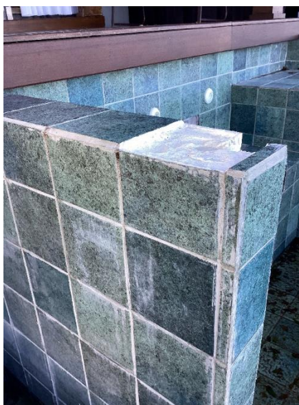
Figura 30 - Presença de eflorescências e peça cerâmica deslocada
