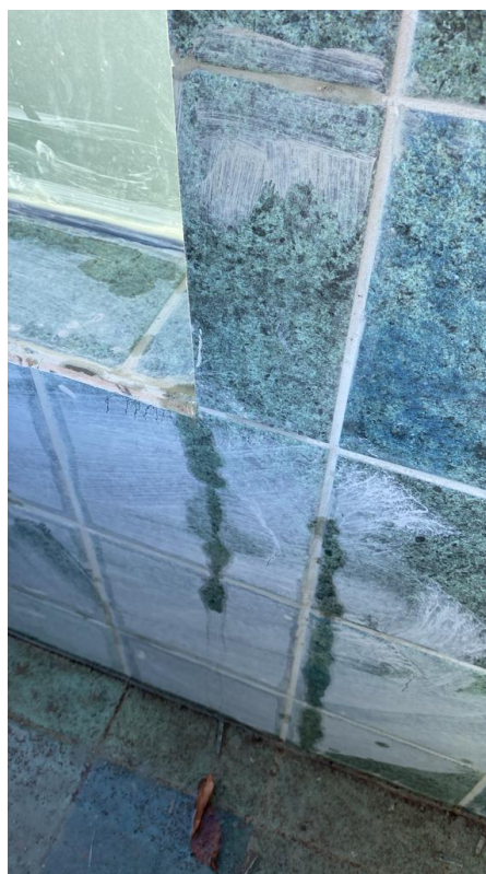
Figura 22 - Vazamentos junto à parede estrutural de vidro
