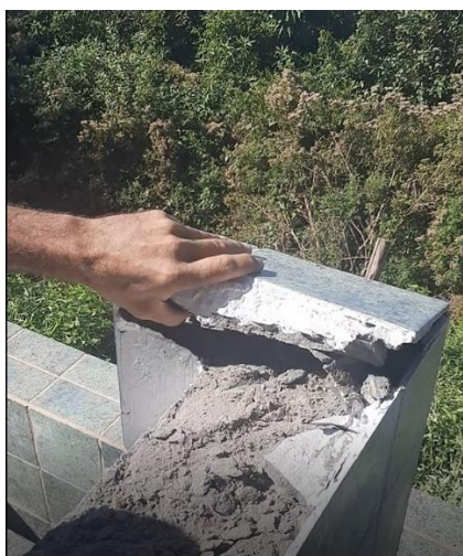
Figura 28 - Grande quantidade de argamassa colante utilizada
