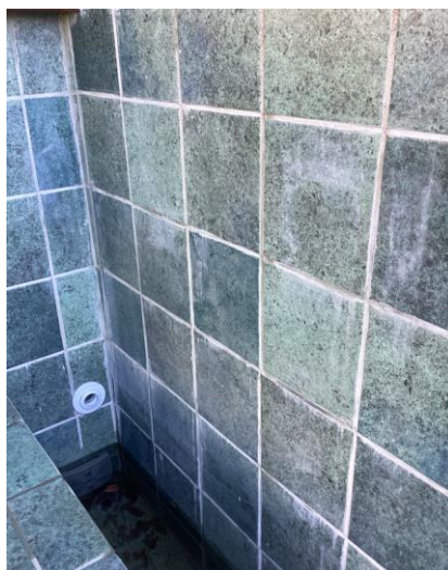
Figura 24 – Eflorescências na parede de uma das piscinas avaliadas
