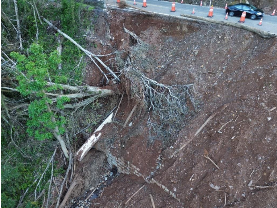
Figura 19 - Bueiro comprometido e defesa de concreto afetada
