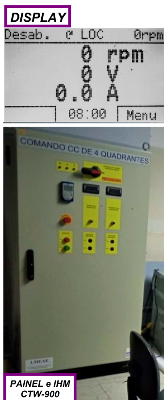
Figura 16 – Painel e IHM do controlador CTW-900.
