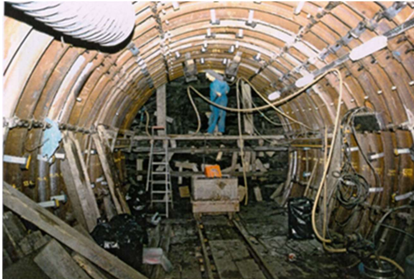
Figura 25 – Vista geral do trecho com cintas metálicas com juntas deslizantes: Galeria de Mol
