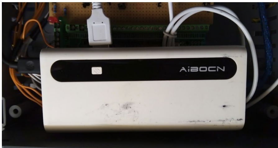
Figura 8: Bateria do controlador.
