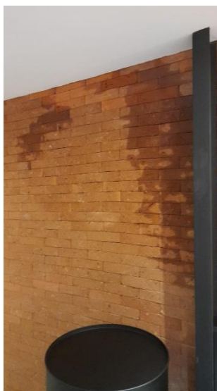
Figura 27– Infiltração por trás do revestimento externo de paredes, no pavimento térreo
