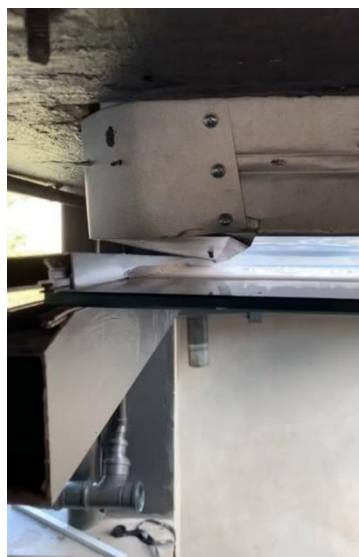
Figura 82 – Rufo metálico não encostado no vidro, facilitando a entrada de água em dias ventosos
