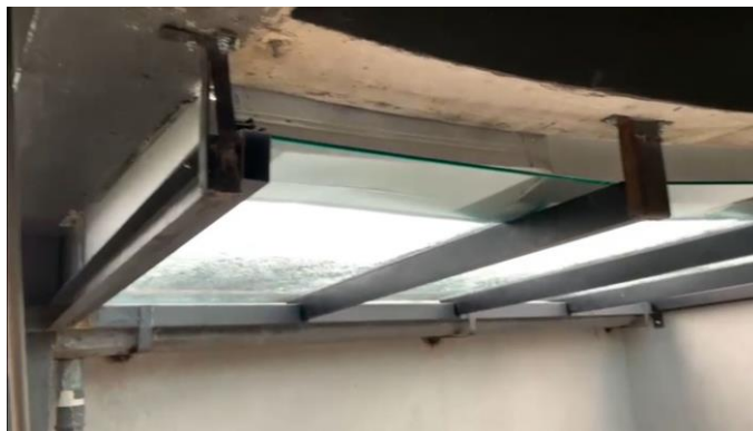
Figura 83 – Telhado de vidro sem acabamento internamente
