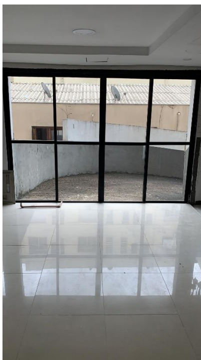
Figura 68 – Rampa de acesso ao 4º andar obsoleta
