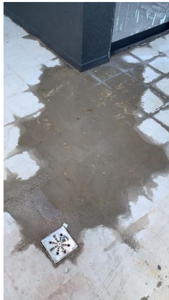
Figura 44 – Ralo mais próximo ainda insuficiente devido ao caimento incorreto
