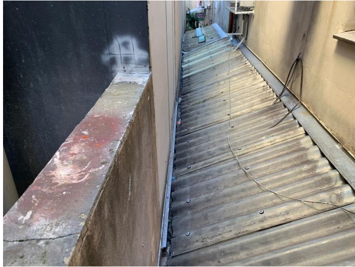
Figura 28 – Calha do prédio vizinho que à época estava totalmente obstruída, gerando a infiltração
