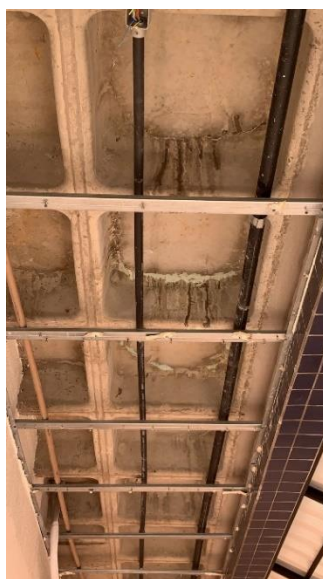
Figura 37 – Uma das infiltrações na laje acima do pavimento da cobertura
