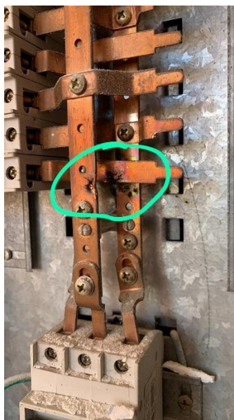
Figura 48 – Barramentos danificados no CD
