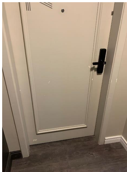
Figura 63 – Pintura das portas descascando em diversos pontos
