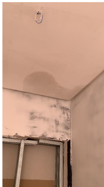
Figura 41 – Forro de gesso molhado no local das infiltrações
