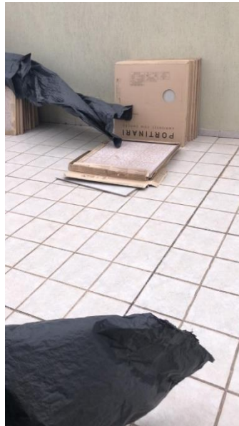
Figura 35 – Placas de porcelanato caídas na área externa da cobertura
