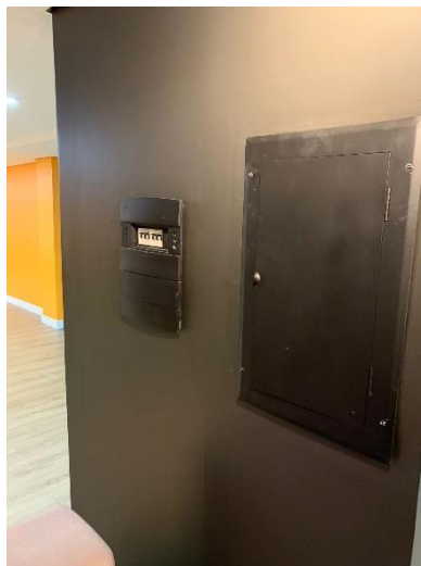
Figura 70 – CDs do 4º pavimento sem tampa e com saliências
