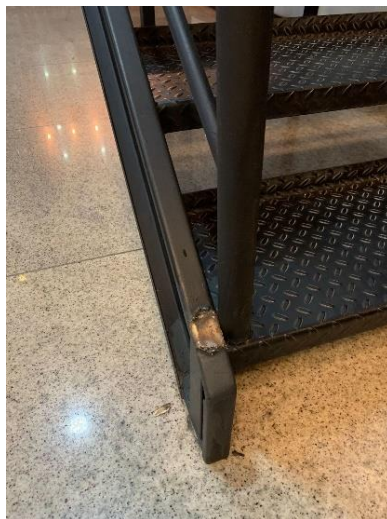
Figura 17 – Ruptura da barra de apoio do corrimão, no ponto de solda
