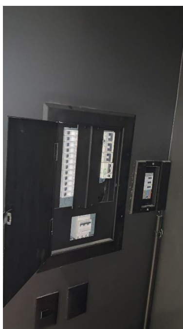
Figura 47 – Circuitos não identificados e CD menor sem tampa
