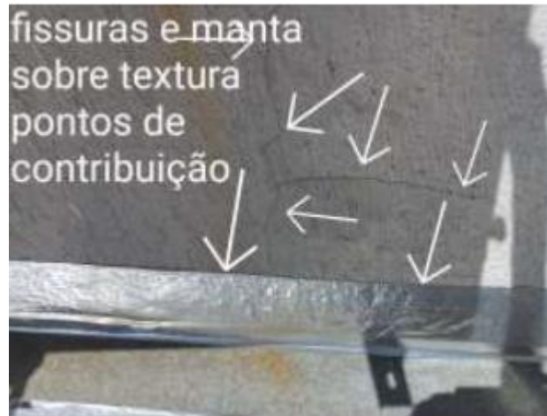
Figura 40 – Pontos de contribuição nas alvenarias
