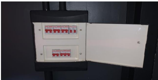
Figura 19 – CD sem identificação dos disjuntores
