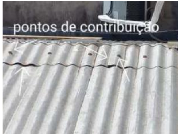
Figura 38 – Telhas amassadas e com os parafusos de fixação oxidados e/ou levantados
