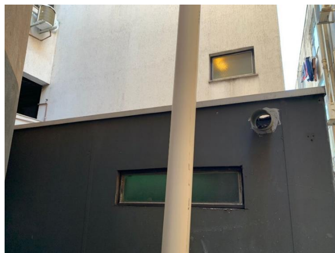
Figura 26 – Extravasor instalado na lateral da calha
