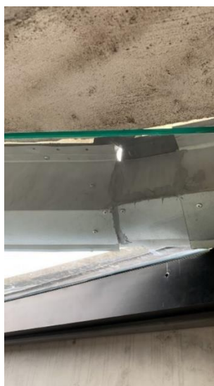
Figura 81 – Abertura que facilita a entrada de água no ponto de sobreposição entre rufos metálicos
