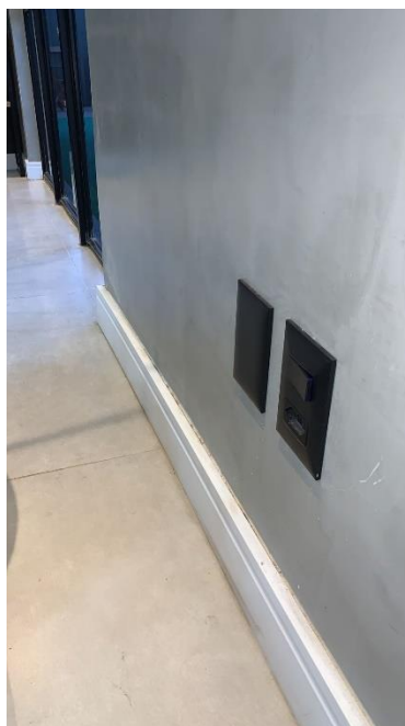
Figura 49 – Interruptor de parte das luminárias externas instalado a 30cm do chão
