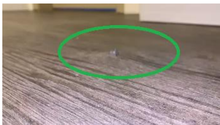
Figura 73 – Piso do 5º pavimento perfurado pelo parafuso de fixação do ar condicionado do pavimento inferior
