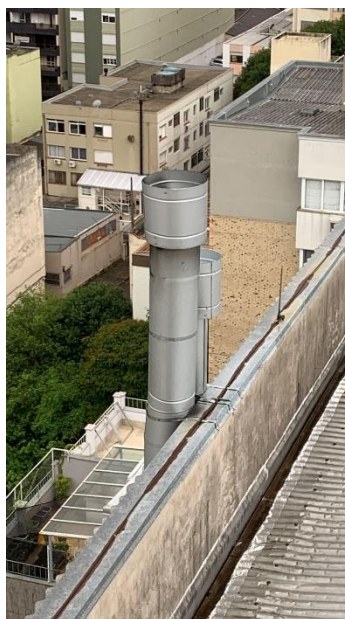
Figura 55 – Chaminé com chapéu de diâmetro insuficiente de 30cm
