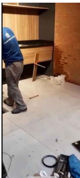
Figura 23 – A mesma tubulação de água fria furada na altura de fixação do móvel
