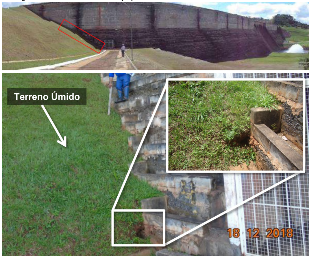
Figura 29 – Umidade no terreno e pequena erosão no contato do talude de terra com o CCR
