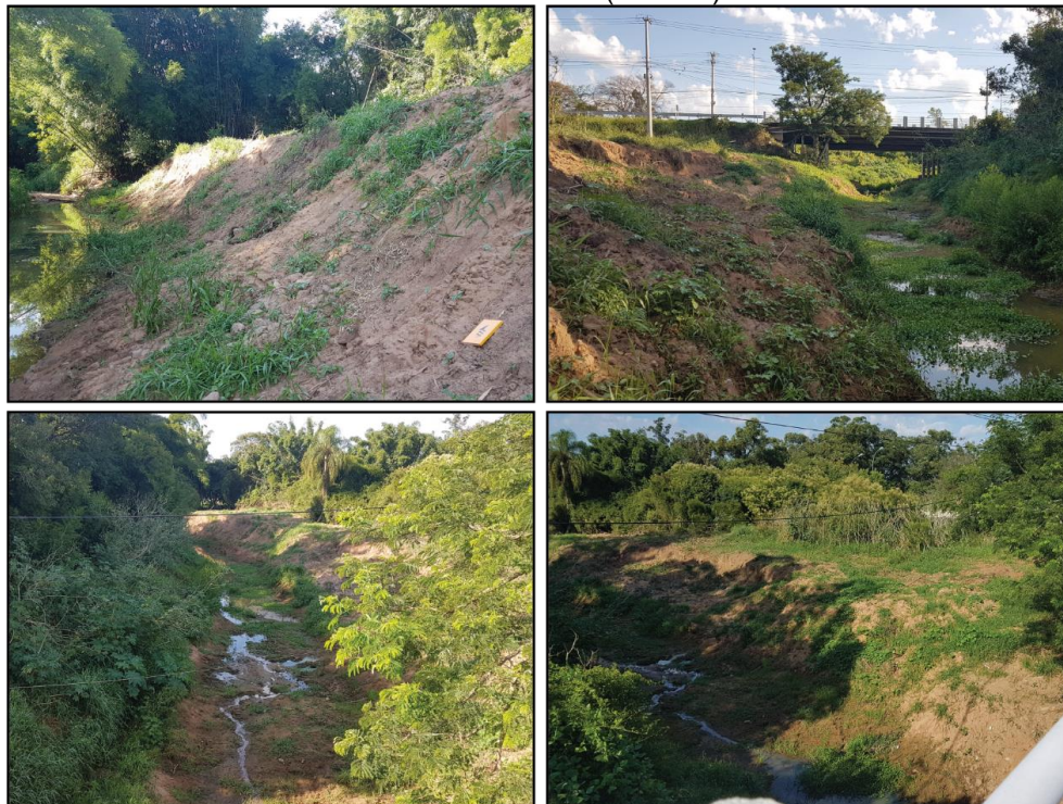
Figura 31 – Depósito aluvial. Detalhe dos sedimentos inconsolidados recobrendo a calha do Arroio Demétrio (RS-030).
