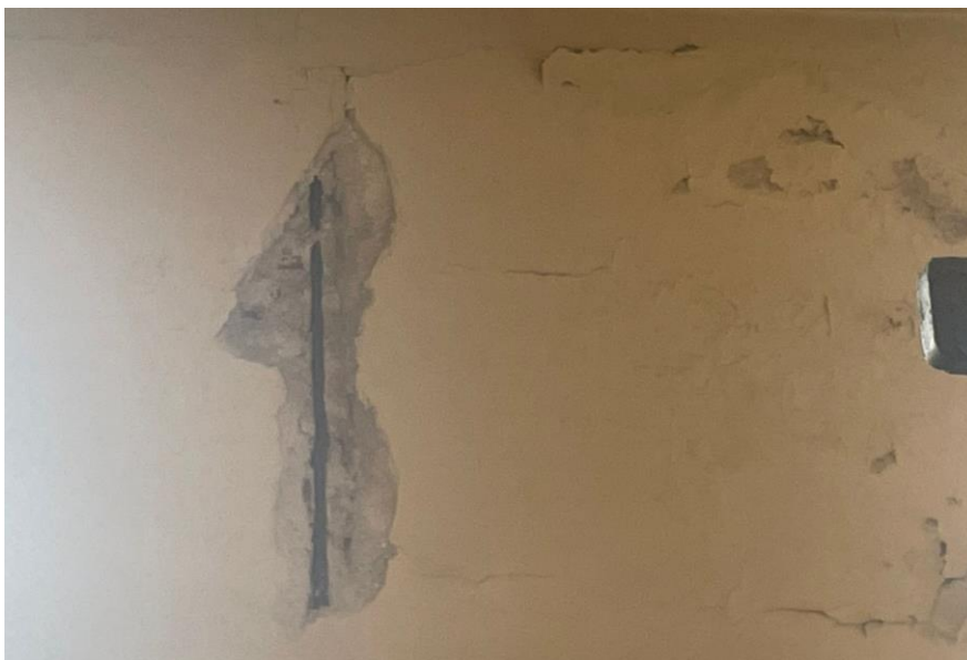
Figura 47: descolamentos, entrada auditório
