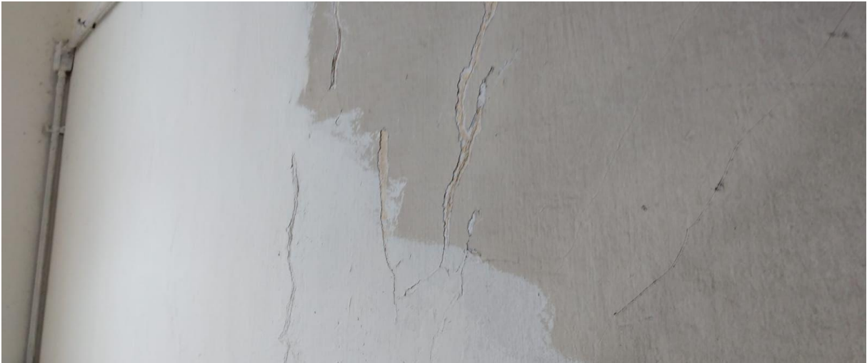
Figura 46: fissuras e nova camada de pintura, entrada auditório (escada)
