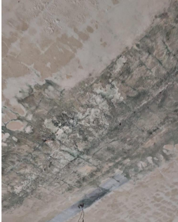
Figura 39: manifestações patológicas diversas no revestimento horizontal, entrada do auditório
