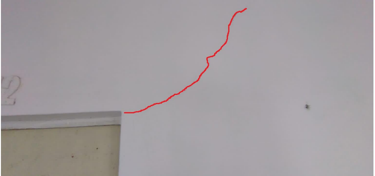
Figura 12: fissura a 45° de inclinação, 2° andar
