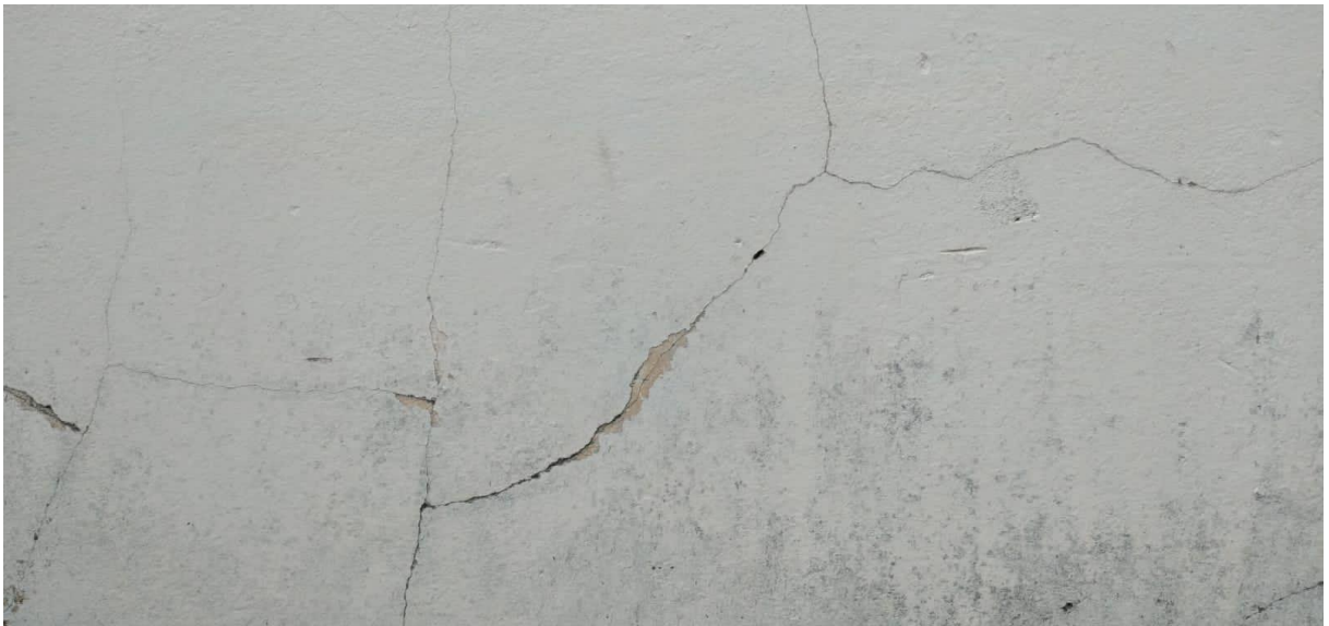
Figura 16: fissuras mapeadas, pátio 1
