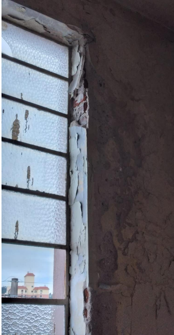
Figura 44: descolamentos, entrada auditório
