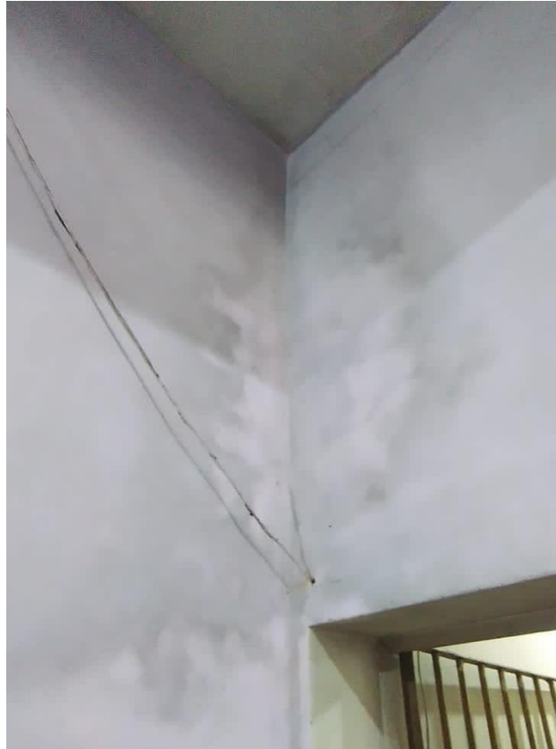
Figura 36: manchamentos, entrada galeria
