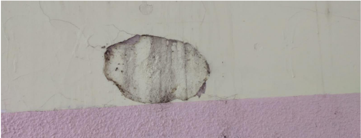
Figura 28: descolamento com pulverulência, pátio interno 2
