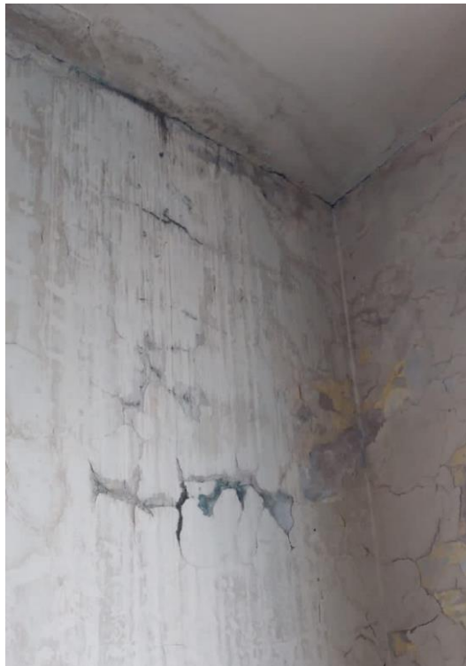
Figura 41: manifestações patológicas diversas no revestimento horizontal e vertical, entrada auditório
