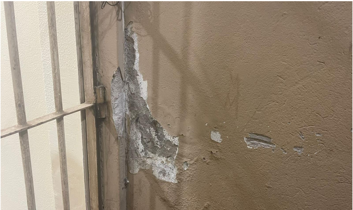
Figura 38: descolamento com pulverulência, entrada galerias
