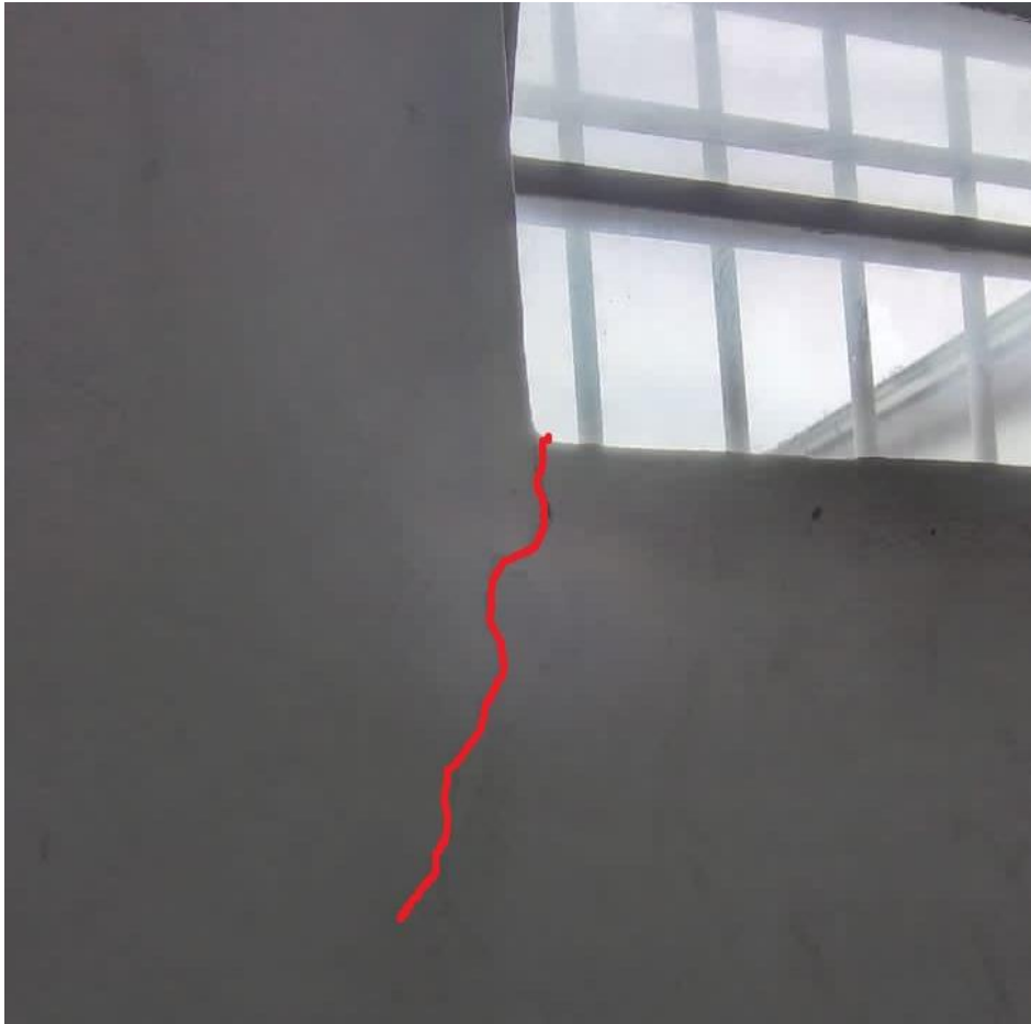
Figura 14: fissura a 45° de inclinação, 2º andar
