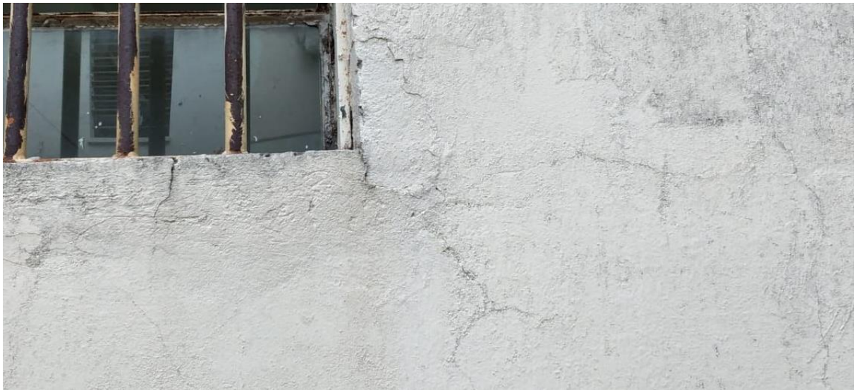
Figura 13: fissura a 45° do canto da janela
