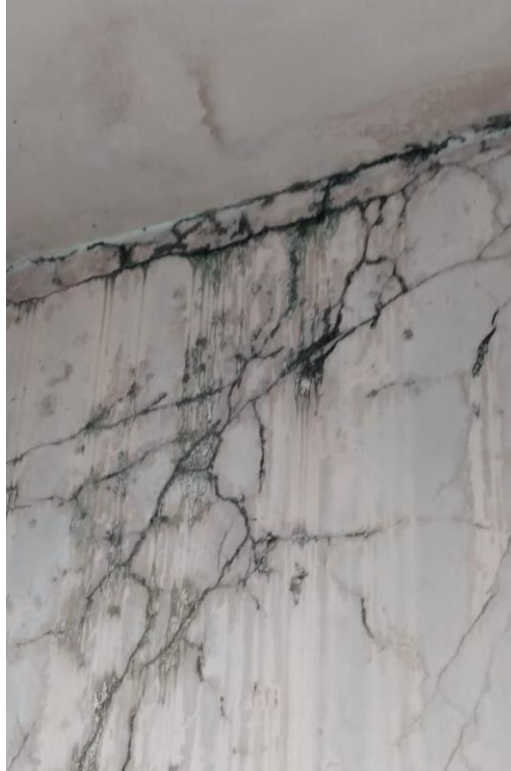
Figura 40: manifestações patológicas diversas no revestimento horizontal e vertical, entrada auditório
