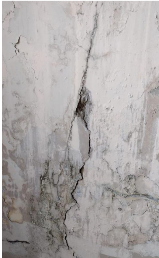
Figura 42: manifestações patológicas diversas no revestimento horizontal e vertical, entrada auditório
