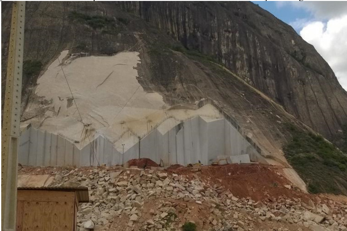
Figura 38 - Talude onde é possível se verificar um tratamento de extração da região instável.
