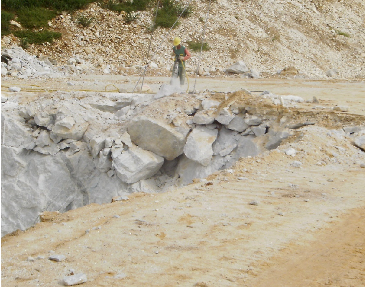
Figura 60 - Região com desmonte recente onde é possível observar blocos soltos no talude.
