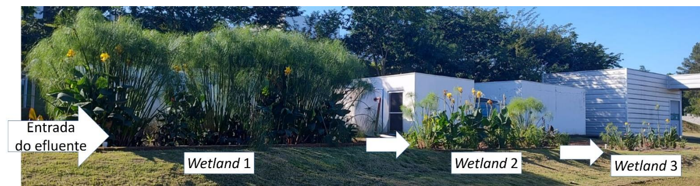
Figura 1: Registro fotográfico das 3 unidades de Wetlands Construídos após aprox. 6 meses de operação.
