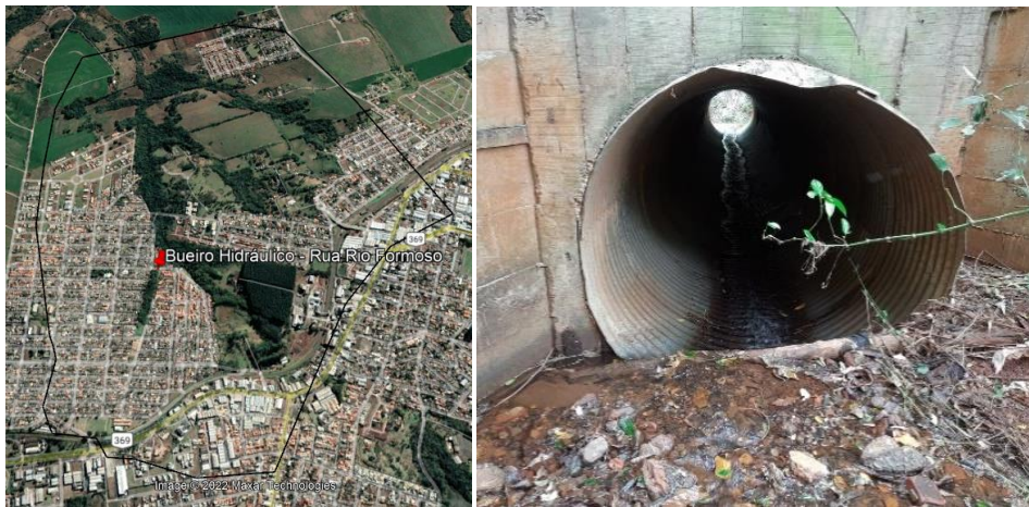
Figura 4: Localização do bueiro hidráulico e modelo tubular aço corrugado. Fonte: Autoria Própria, adaptado de Google Earth Pro (2022).
