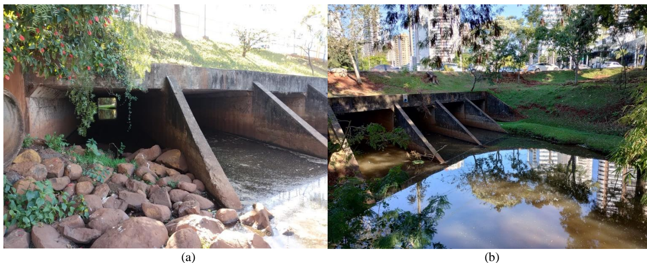
(a) (b) Figura 7: Bueiro celular obstruído entre o lago Igapó II e o ribeirão Cambé, ao lado do aterro. Fonte: Autores, 2023.
