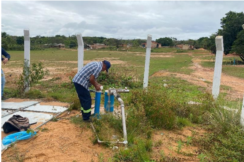
Figura 6: Aplicação das pastilhas de cloro no poço por funcionário da CAER
