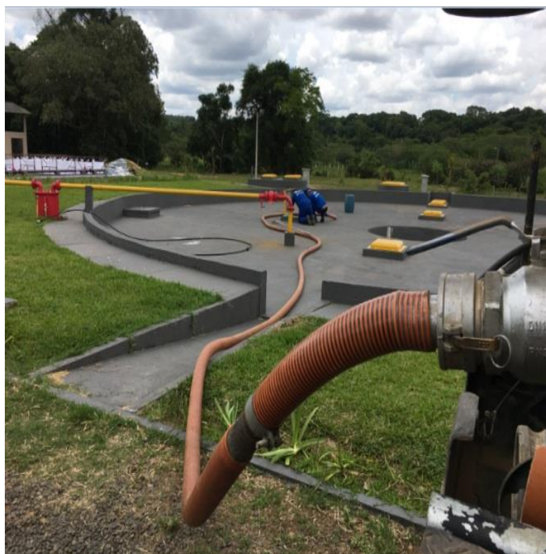
Figura 6 - Retirada de espuma com caminhão de sucção Fonte - David Garcia
