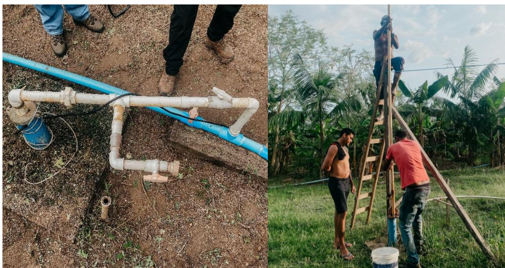
Figura 3: Reconhecimento da área, (a) Encanamento fora da vida útil, necessitando de manutenção e troca e (b) Momento em que os próprios moradores realizavam manutenção do poço. Fonte: Os autores.
