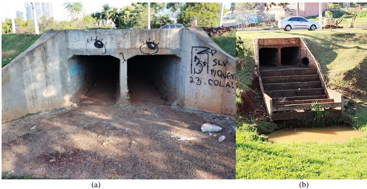
(a) (b) Figura 10: Bueiro de grotá celular duplo no lago Igapó III. Fonte: Autores, 2023.
