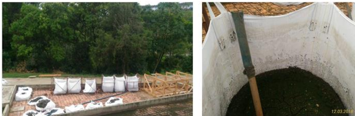
Figura 9 - Desaguamento de lodo de processo físico-químico.
