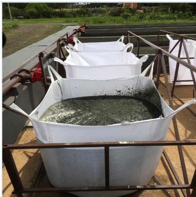
Figura 4 - Big Bags instalados sobre o leito de secagem em estruturas metálicas Fonte - David Garcia
