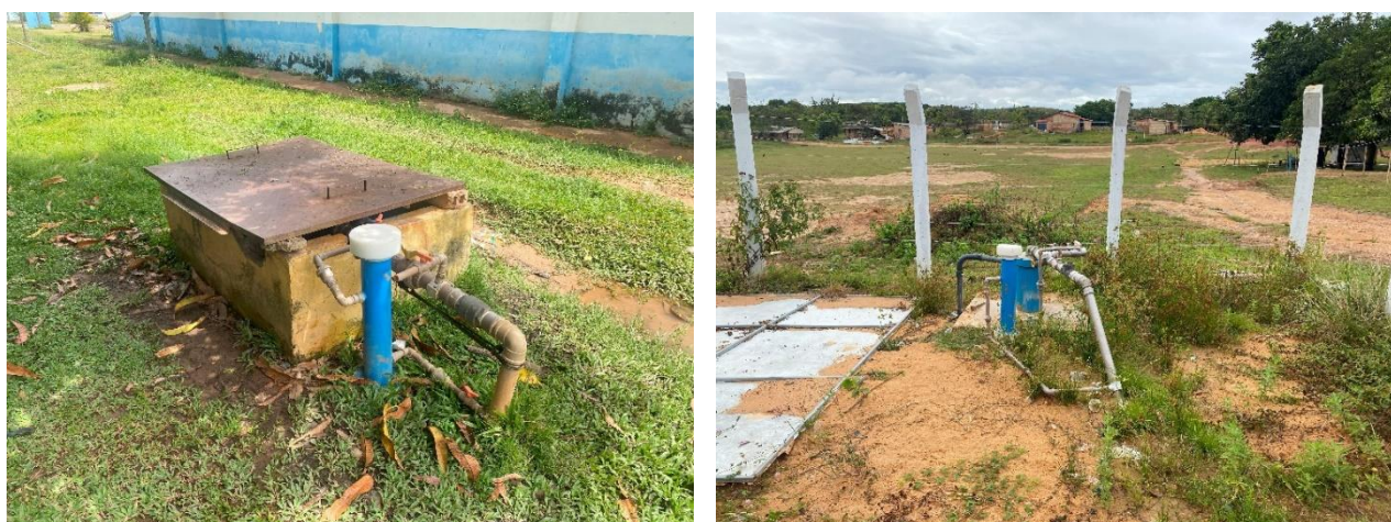
Figura 4 e 5: Poços de água tratada da Companhia de Águas e Esgotos de Roraima
