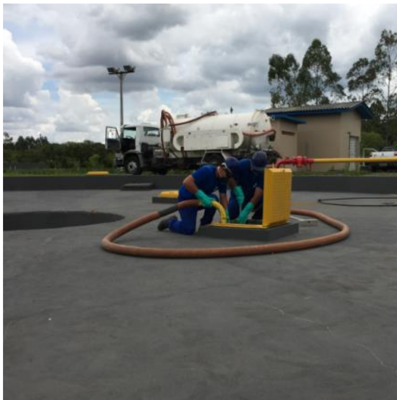
Figura 5 - Retirada de espuma com caminhão de sucção Fonte - David Garcia
