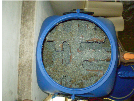
Figura 4.11: Vista interna do filtro biológico
