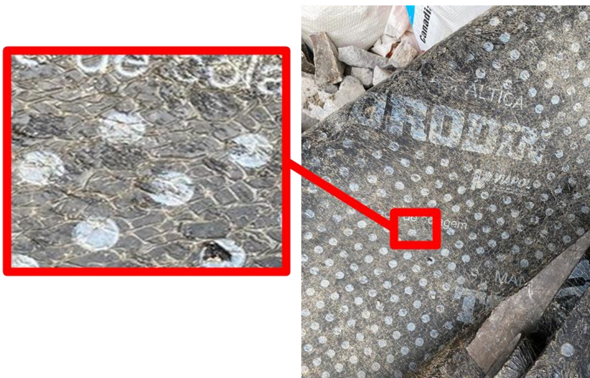
Figura 9: Manta asfáltica fissurada
