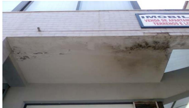
Figura 12 - Manchas decorrentes da umidade
