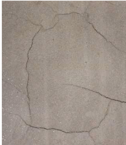
Figura 7 - Detalhe de fissuras mapeadas
