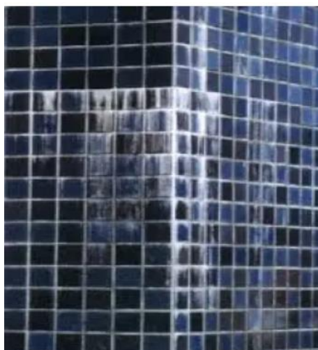
Figura 15 - Eflorescência em revestimento cerâmico
