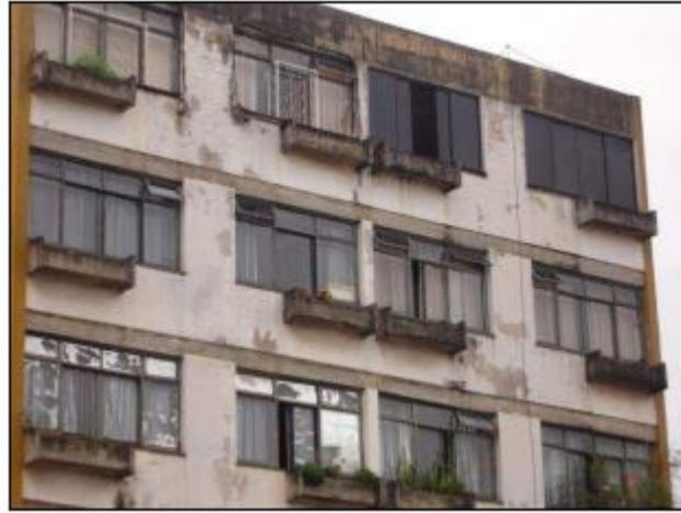
Figura 8 - Bolor sobre fachada de edifício
