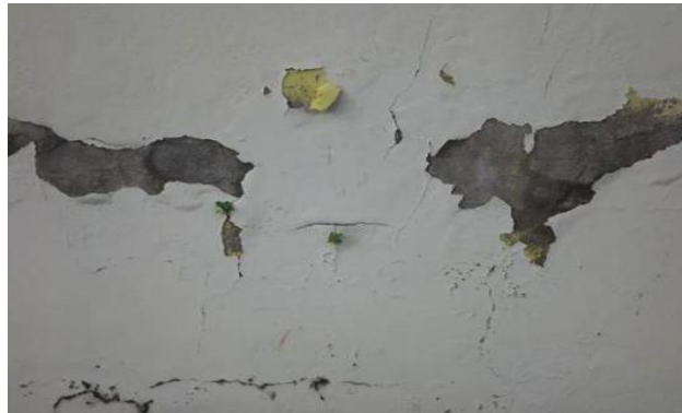
Figura 11 - Descascamento de pintura
