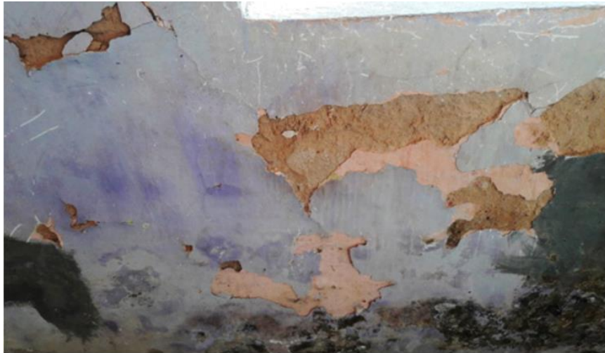
Figura 10 - Detalhes de desagregação em fachada
