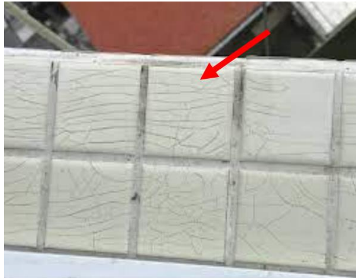
Figura 14 - Gretamento no revestimento cerâmico
