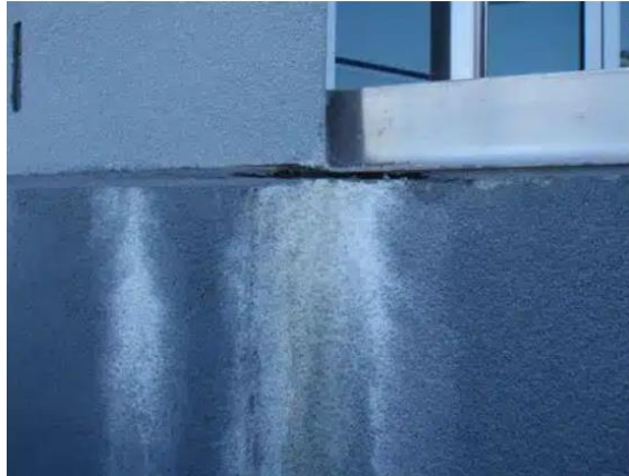
Figura 9 - Detalhes de eflorescência
