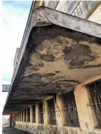
Figura 18 - Manchas no revestimento da marquise sul
