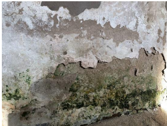
Figura 39 - Desprendimento do revestimento impulsionado pela umidade por capilaridade
