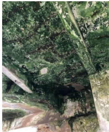
Figura 20 - Manchas pretas e esverdeadas na parte inferior de laje.
