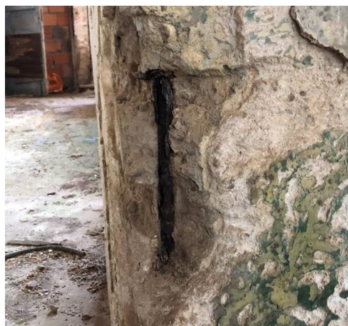
Figura 24 - Armadura exposta com indícios de corrosão
