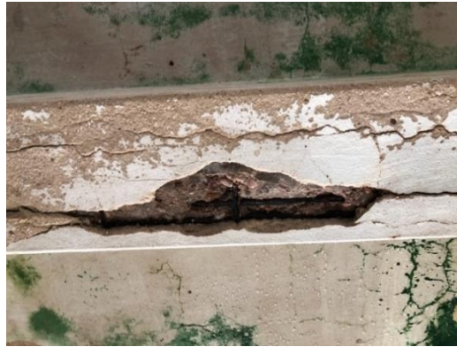
Figura 26 - Fissuração e deslocamento na base de viga
