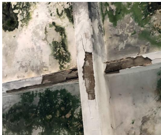
Figura 23 - Vista inferior de vigas com indícios de corrosão
