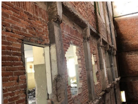
Figura 25 - Estruturas de concreto armado deterioradas
