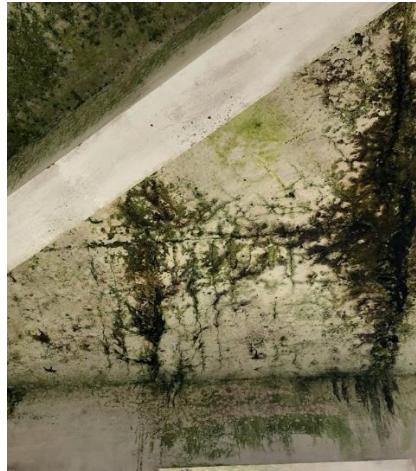
Figura 36 - Fissuras no alinhamento das armaduras positivas com pigmentação verde e marrom
