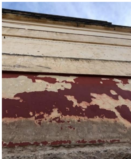
Figura 40 - Descascamento da camada superficial de pintura na fachada leste
