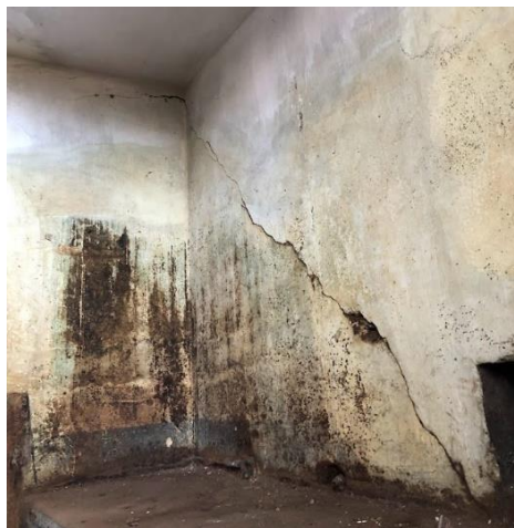
Figura 37 - Trica inclinada em alvenaria
