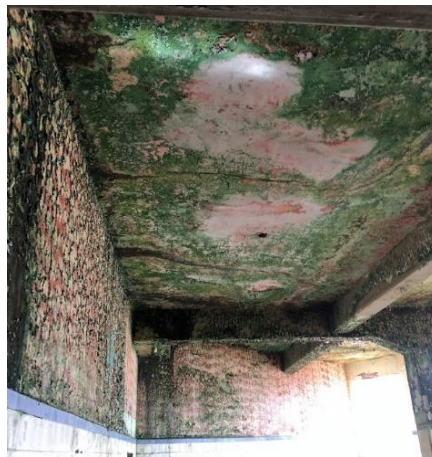
Figura 35 – Manchas escuras e biodeterioração
