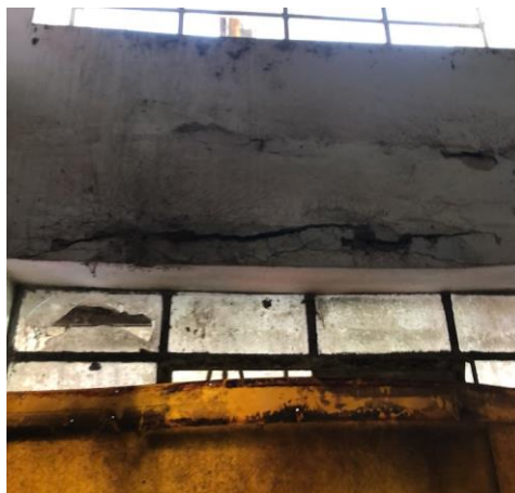
Figura 29 – Indícios de corrosão na viga de ancoragem da marquise sul
