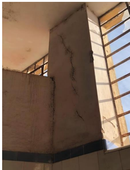
Figura 34 - Fissuras inclinadas em revestimento de pilar.
