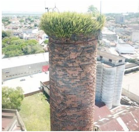
Figura 38 – Trinca no topo da chaminé
