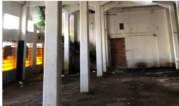
Figura 22 - Manchas de umidade na base da alvenaria
