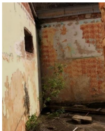
Figura 31 - Presença de vegetação e deterioração completa do telhado nos antigos dormitórios.
