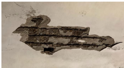
Figura 27 - Armadura corroída sem cobrimento
