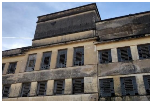
Figura 17 - Manchas no revestimento da fachada sul
