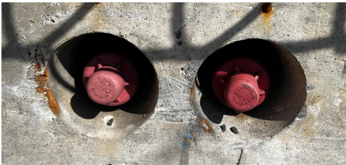
Figura 128 – Vista do cap de proteção após corte dos cabos em dupla de cordoalhas
