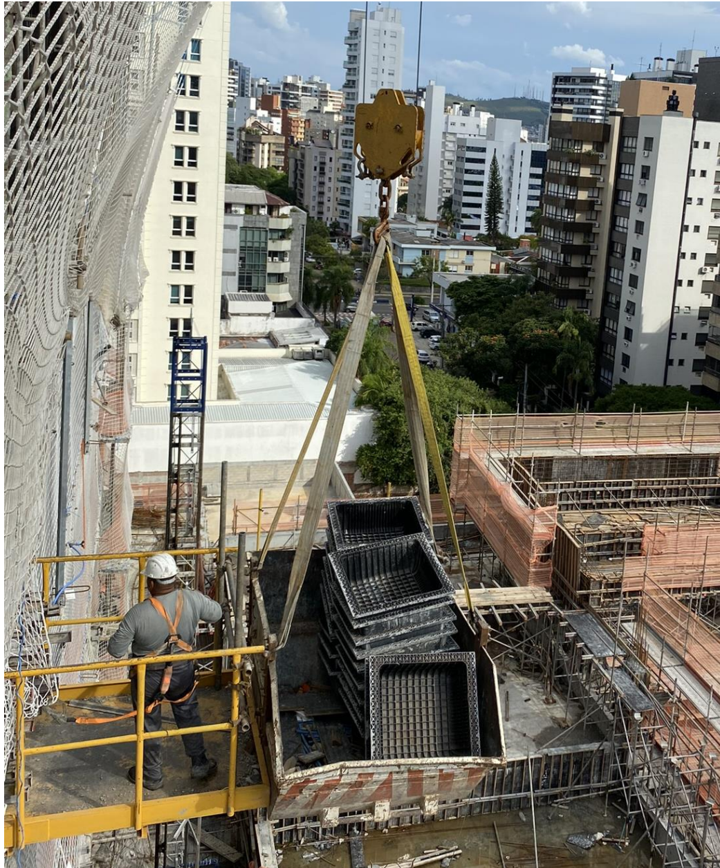
Figura 49 – Posição de carregamento das cubetas, com a grua suportando o container que é abastecido pelo trabalhador na plataforma metálica
