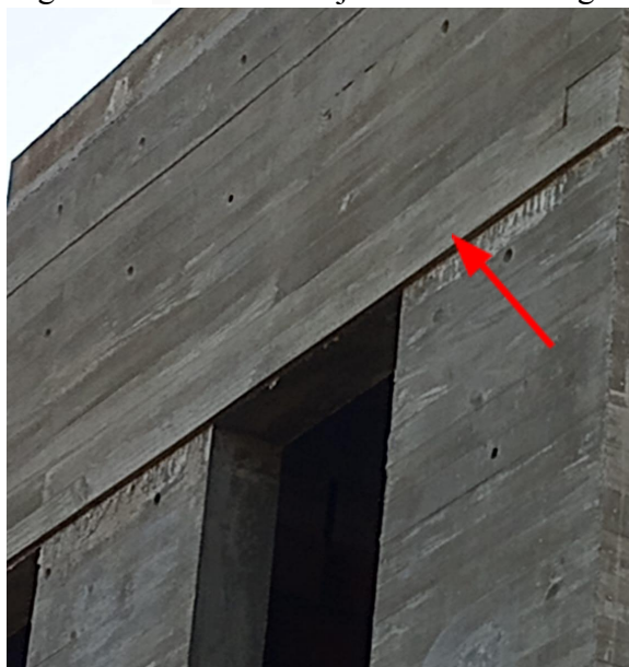
Figura 43 – Detalhe na junta de concretagem
