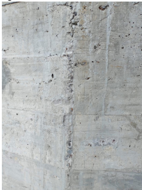
Figura 50 – Bolhas de ar - fachada A
