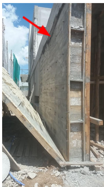
Figura 47 – Desforma do pilar-parede C
