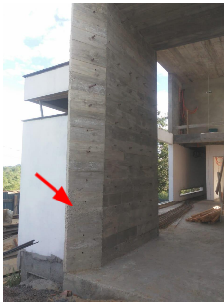
Figura 52 – Segregação - fachada D
