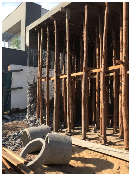
Figura 46 – Destruição do pilar-parede C
