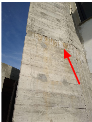
Figura 32a – Manchas devido ao escorrimento do óxido de ferro das esperas das barras de armaduras - Fachada A
