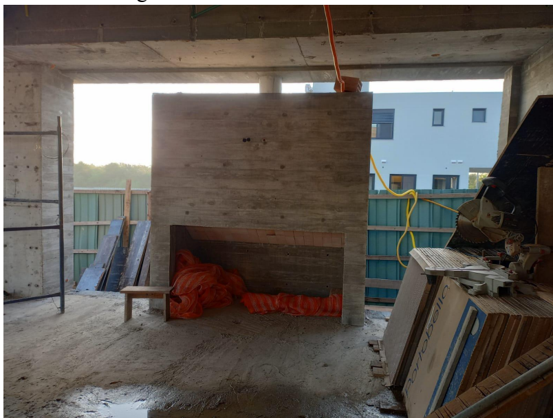
Figura 2 - Elemento interno - Lareira
