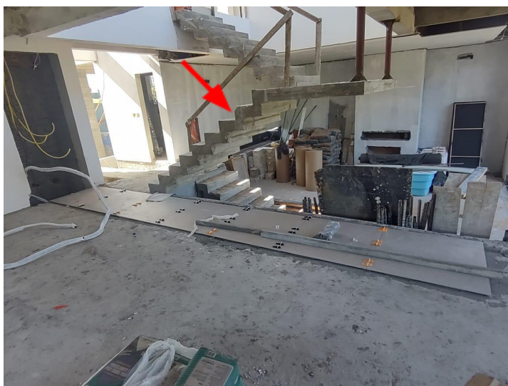
Figura 41 – Quebra dos vértices da escada E
