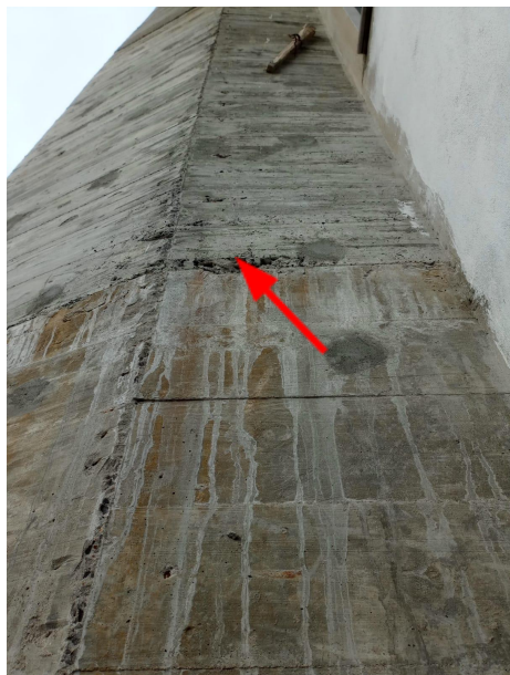
Figura 51 – Segregação - fachada A
