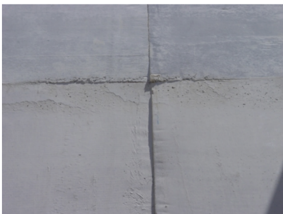
Figura 5 – Aspecto de parede em concreto aparente com desencontro de juntas das fôrmas
