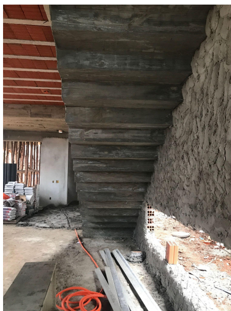
Figura 35 – Desforma da escada C
