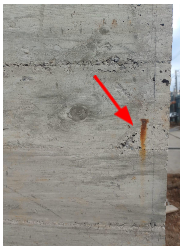
Figura 32b – Mancha devido ao escorrimento do óxido de ferro dos pregos das fôrmas - Fachada A
