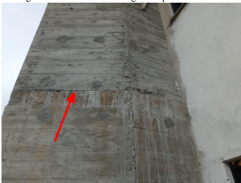
Figura 42 – Junta de concretagem no pórtico A
