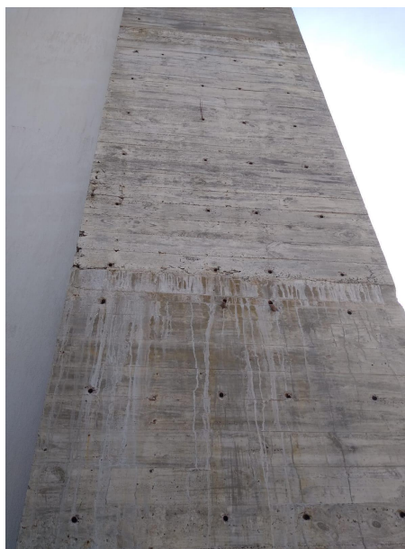
Figura 31 – Mancha devido ao escorrimento da pasta de cimento - Fachada A
