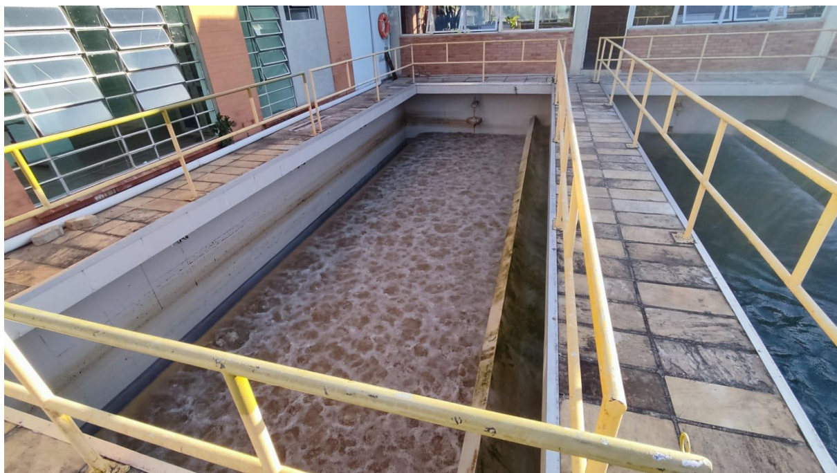
Figura 5 - Lavagem do Filtro
