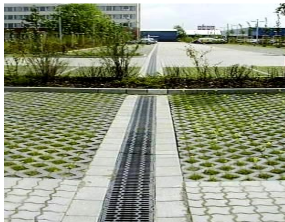
Figura 42. Trincheira de Infiltração em estacionamento. Fonte: Aquafluxus (2012).
