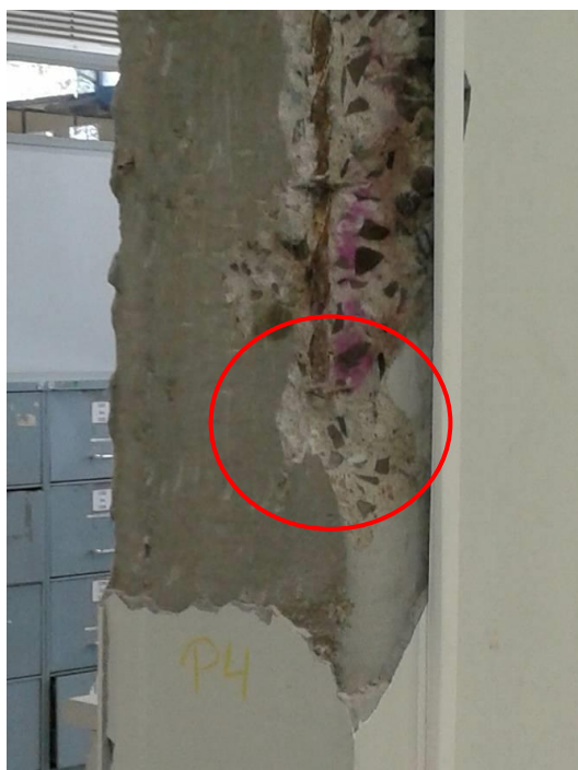
Figura 3: carbonatação ponto 4 - pilar 4 no térreo
