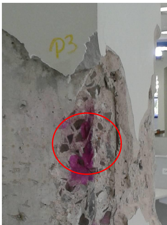
Figura 2: carbonatação ponto 3 - Pilar 3 no térreo
