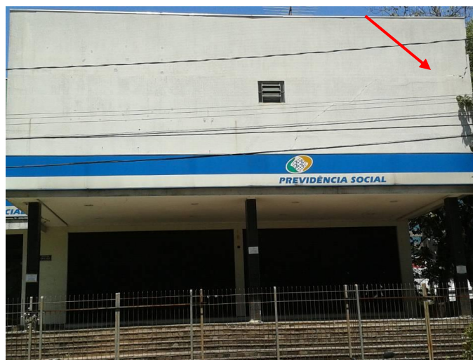
Figura 5: fissura a 45° ocasionada por recalque de fundações
