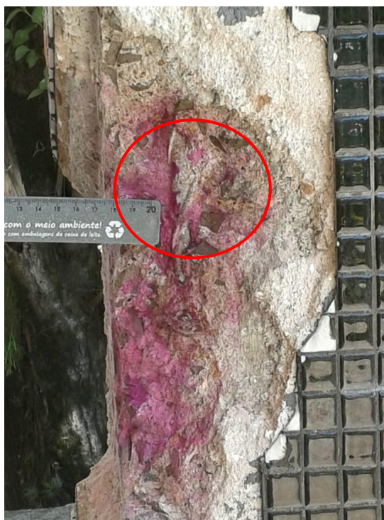
Figura 4: carbonatação ponto 5 – pilar 5 na área externa
