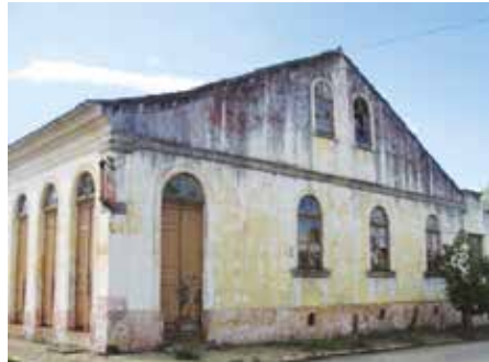
Figura 6. Arquitectura doméstica en la ciudad baja, damnificada por falta de mantenimiento. Fotografía: André Recamonde Thies.
