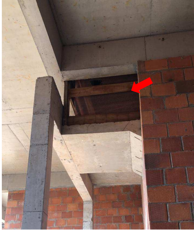
Figura 26: Patamar original da escadaria não fornece apoio para a alvenaria de fechamento da escada
