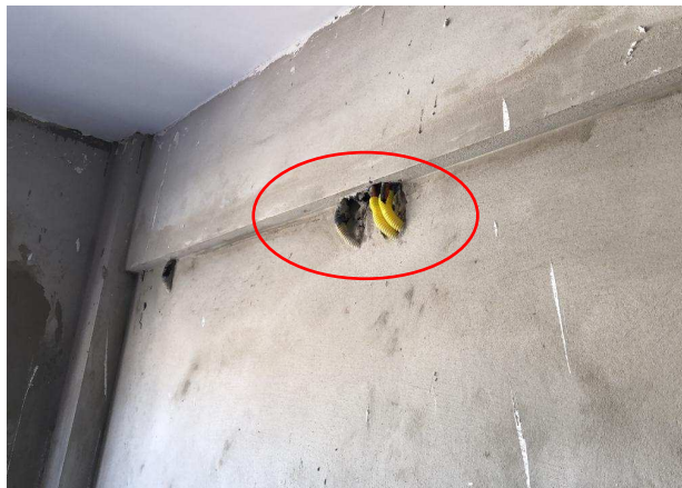
Figura 28: Incompatibilidade envolvendo as disciplinas de elétrica, estrutura e modulação de paredes
