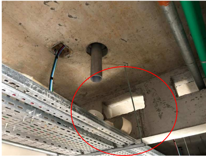
Figura 18: Desvio realizado nas eletrocalhas do 13º pavimento devido à presença da descida do sistema de coleta de água da cobertura
