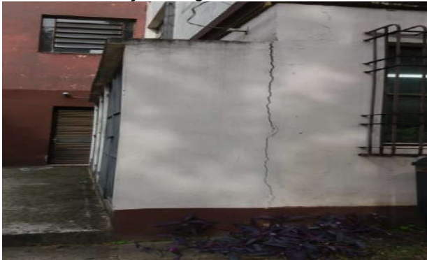
Figura 7 - Fissura decorrente de união de elementos novos à construção antiga
