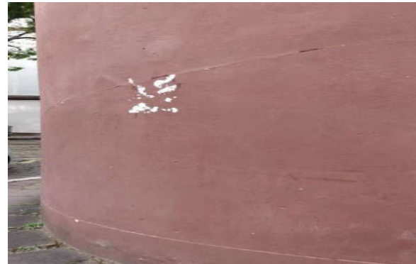
Figura 8 - Fissura decorrente de problemas estruturais
