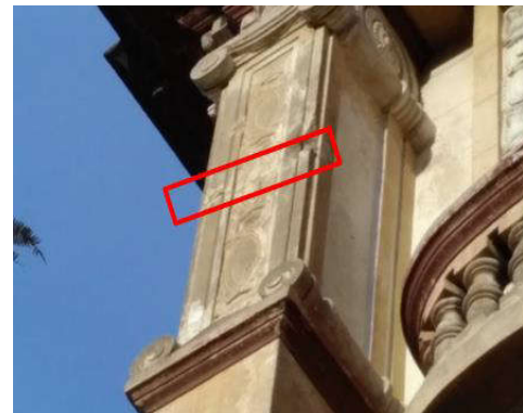
Figura 19- Fissuras decorrentes de problemas estruturais
