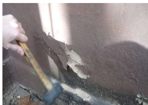
Figura 15- Descolamento com pulverulência e empolamento
