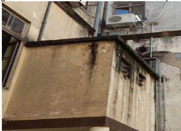
Figura 10- Biodeterioração e descolamento da pintura
