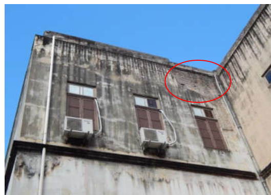
Figura 12- Deslocamento do revestimento
