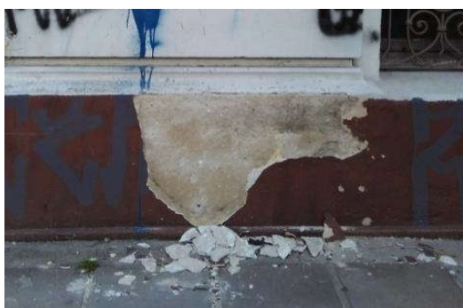
Figura 14- Deslocamento do revestimento argamassado
