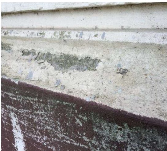
Figura 21 - Descolamento da pintura e presença de biodeterioração
