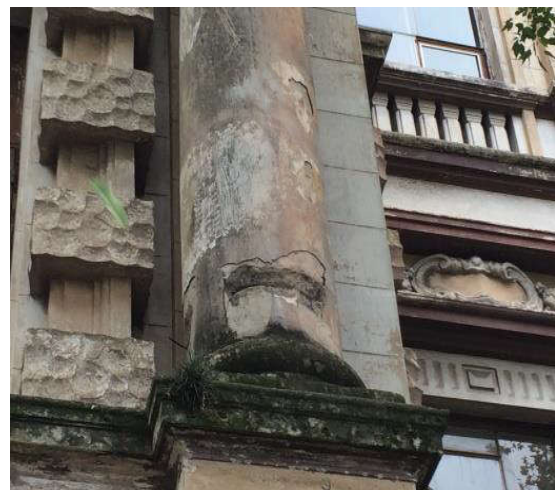
Figura 22 - Desplacamento de revestimento e deterioração da camada de cobertura estrutural
