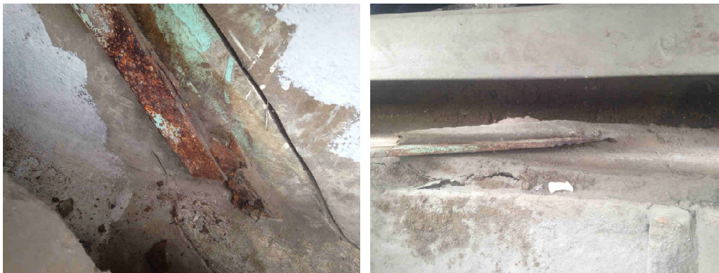
Figura 4: Ruptura do tirante de reforço por corrosão.
