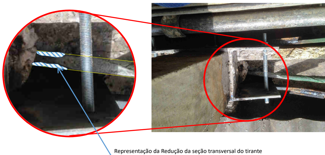
Figura 5: Detalhe da redução da seção transversal do tirante devido a corrosão.
