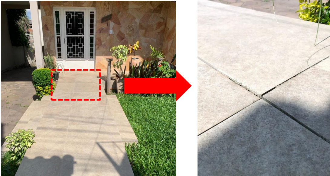
Figura 9 - Visão frontal da região com deslocamento de piso na área externa
