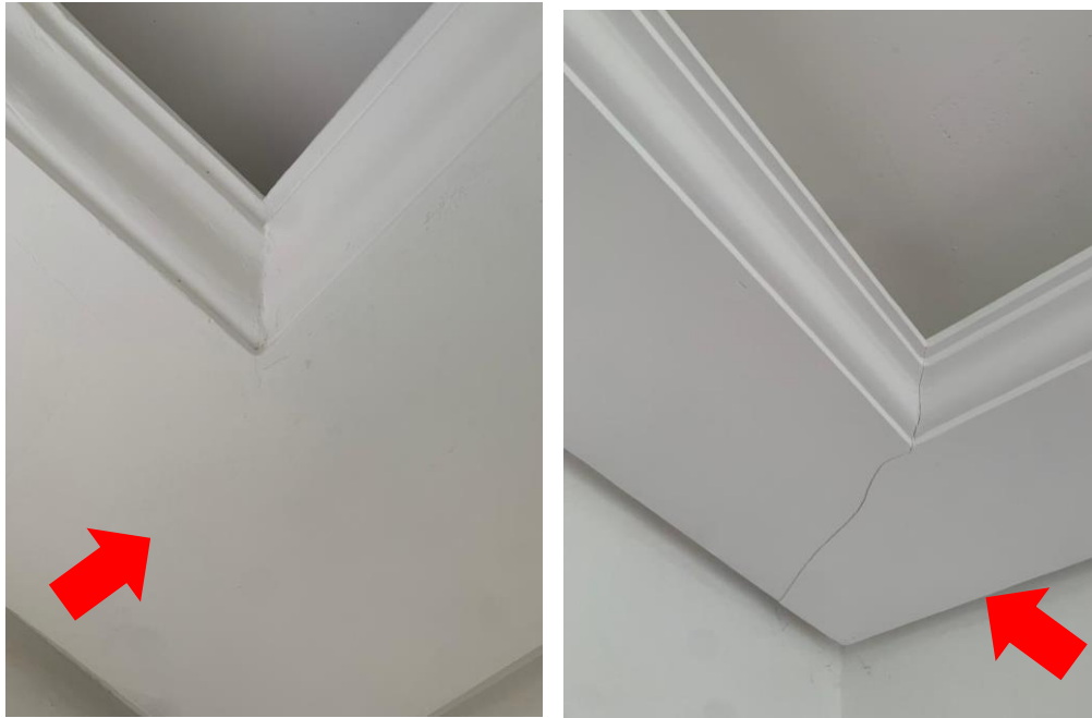
Figura 21 – fissuras nas quinas do forro de gesso
