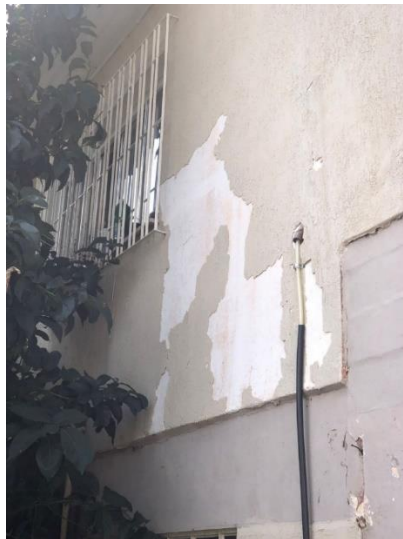
Figura 24 –Descolamento da textura externa
