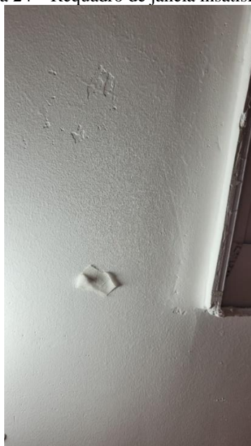
Figura 24 – Requadro de janela insatisfatória
