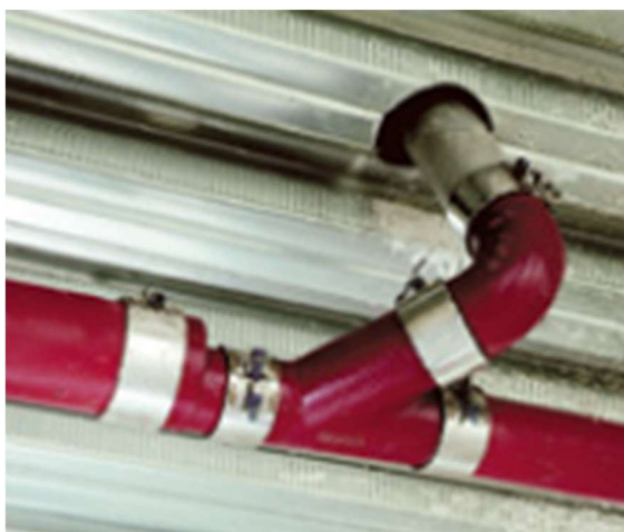
Figura 9 – Ligação em ferro fundido do tubo do captador com o condutor vertical.
