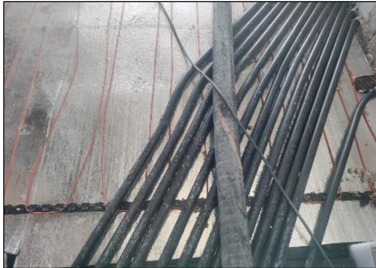
Figura 45 - Cruzamento de mangote e instalações elétricas
