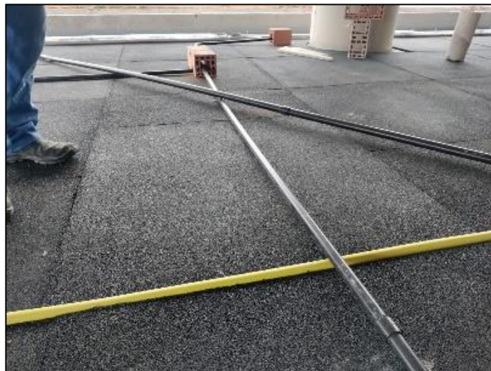
Figura 43 - Interferências de trajetos de instalações de elétrica e gás
