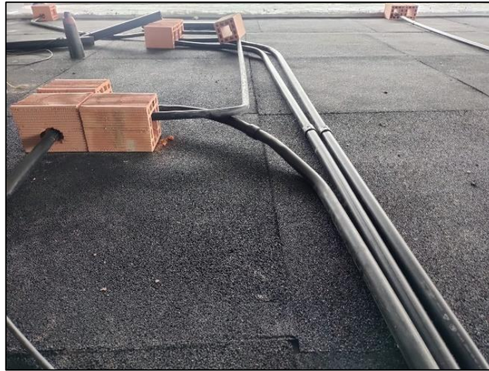
Figura 44 - Interferências de trajetos de instalações de elétrica
