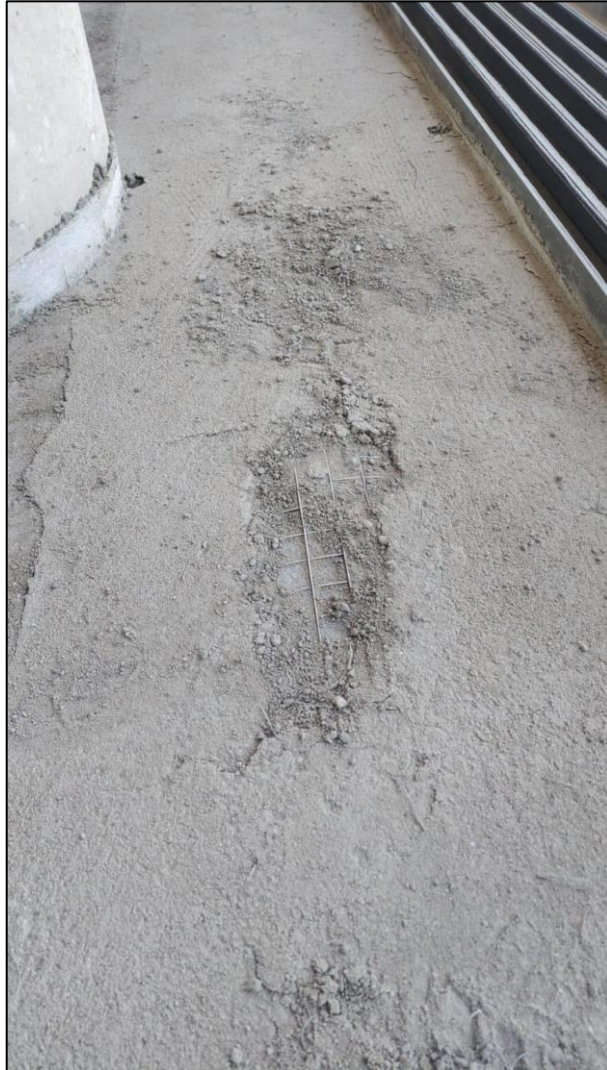
Figura 74 - Patologia causada no contrapiso devido à mureta
