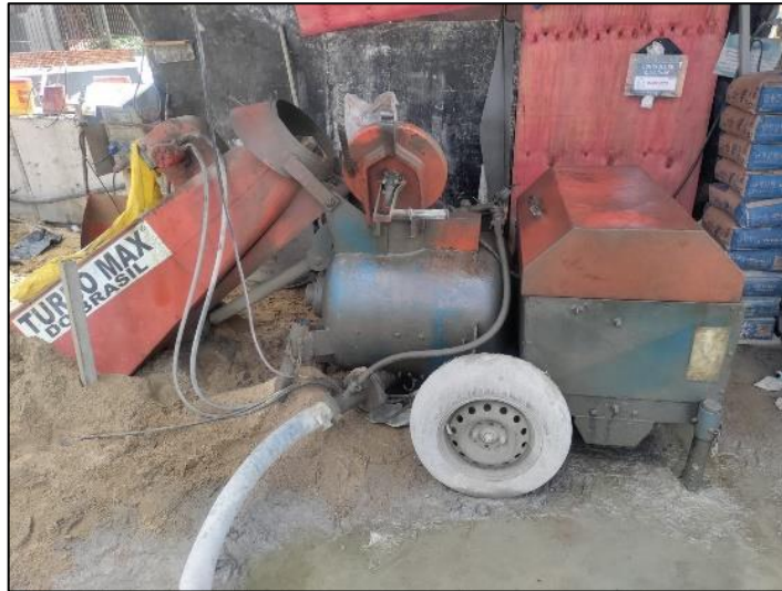
Figura 28 - Misturador de argamassa utilizado
