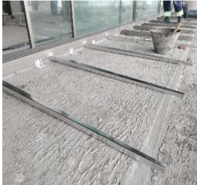
Figura 65 - Drenagem da esquadria voltada para a varanda
