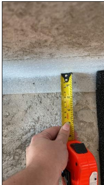
Figura 34 - Rodapé instalado com dimensão da virada inferior ao estipulado
