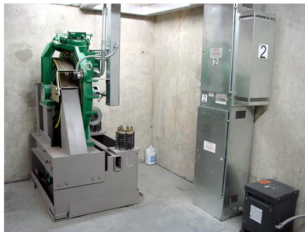
Figura 2 - Casa de máquinas.
