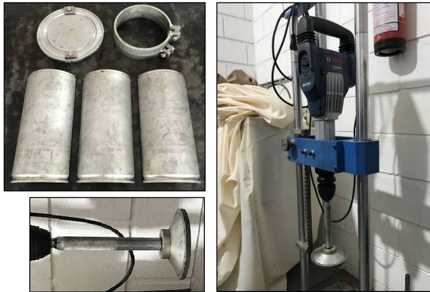
Figura 25 - Molde tripartido (à esquerda acima), detalhe da ponteira (à esquerda abaixo) e visão geral do pórtico e do martelo demolidor (à direita).
