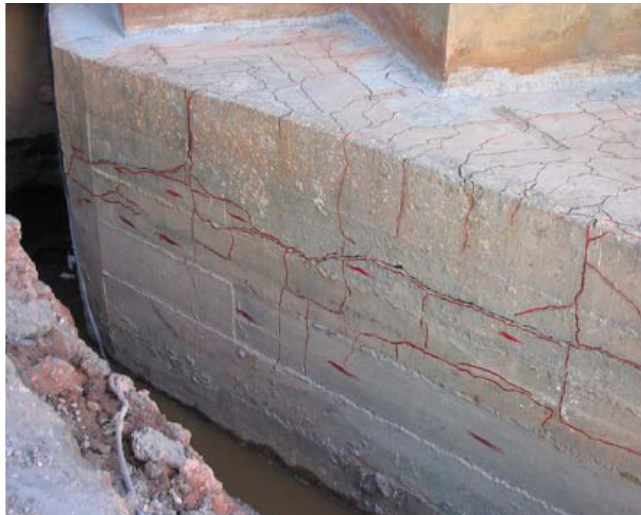
Figura 12: bloco de fundação com fissuras mapeadas na face superior e alinhadas com a armadura na face lateral (ANDRADE, 2006, p. 8)
