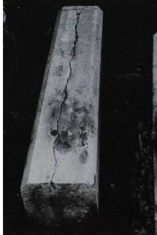
Figura 11: fissuras em uma coluna levemente protendida (HOBBS, 1988, p. 17)
