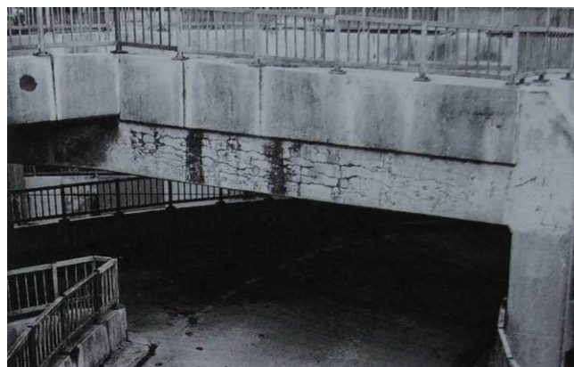
Figura 10: fissuras em uma viga super armada (HOBBS, 1988, p. 17)
