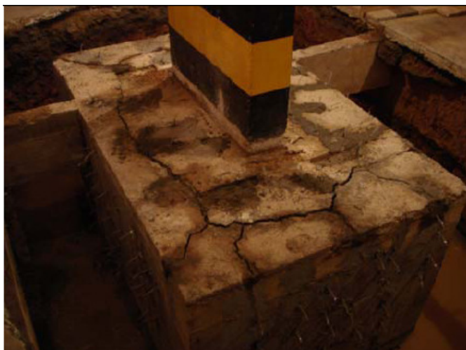
Figura 2: bloco de fundação num edifício comercial em Recife/PE com a superfície superior intensamente fissurada devido à reação álcali-agregado (ANDRADE, 2006, p. 5)
