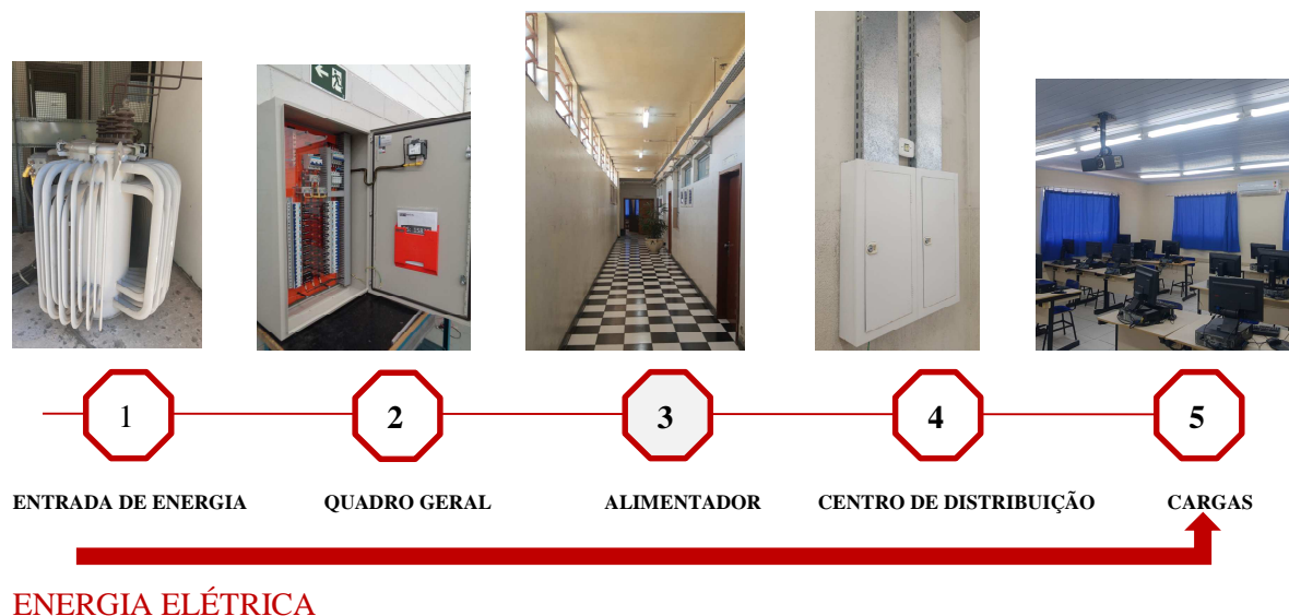
Figura 3.2 – Diagrama ilustrativo da alimentação de energia elétrica – Da Entrada até a carga.
