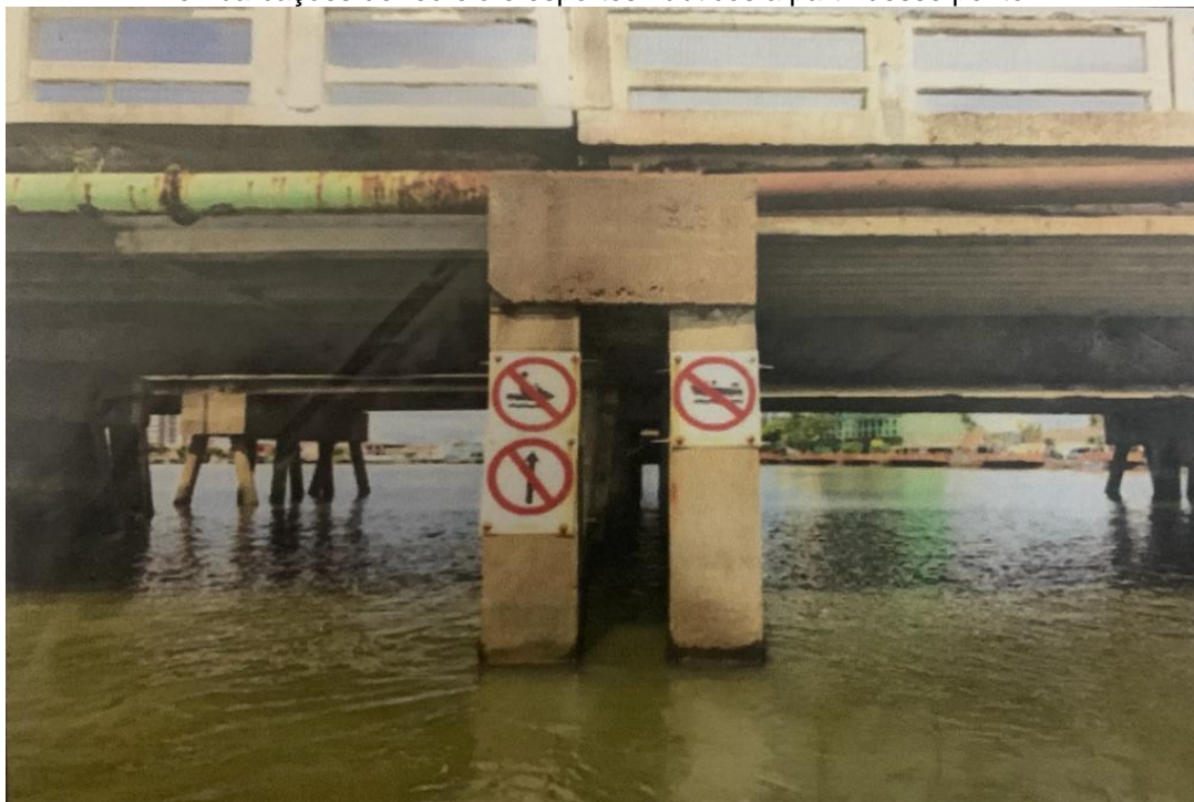
Figura 6 - Placas instaladas na ponte, no ano de 2015, a fim de sinalizar a proibição de embarcações de recreio e esportes náuticos a partir desse ponto.
