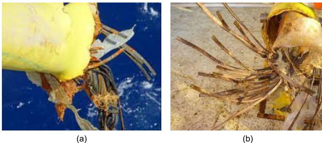
Figura 4 – Falha operacional de duto flexível: (a) duto rompido e (b) aspecto dos arames da armadura de tração
