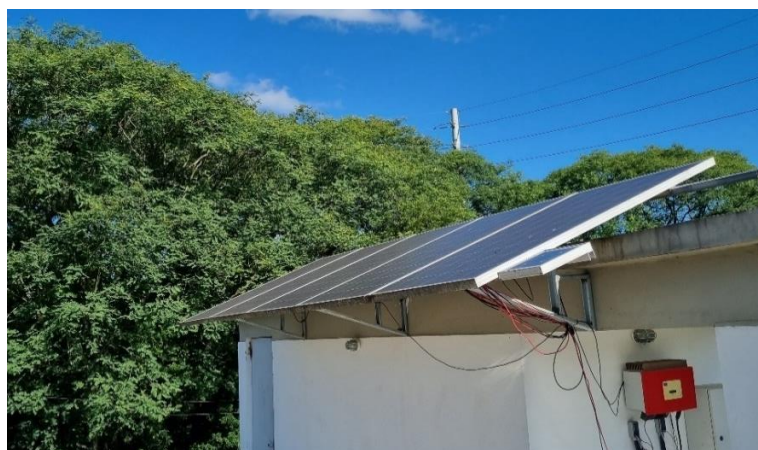
Figura 3.4 – Sistema FV instalado no LABSOL em Porto Alegre (UFRGS)
