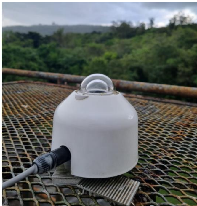
Figura 3.5 - Piranômetro instalado na cobertura do LABSOL para medir irradiação solar global no plano horizontal
